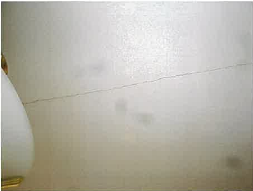
14 同上 天井の ひび割れ
