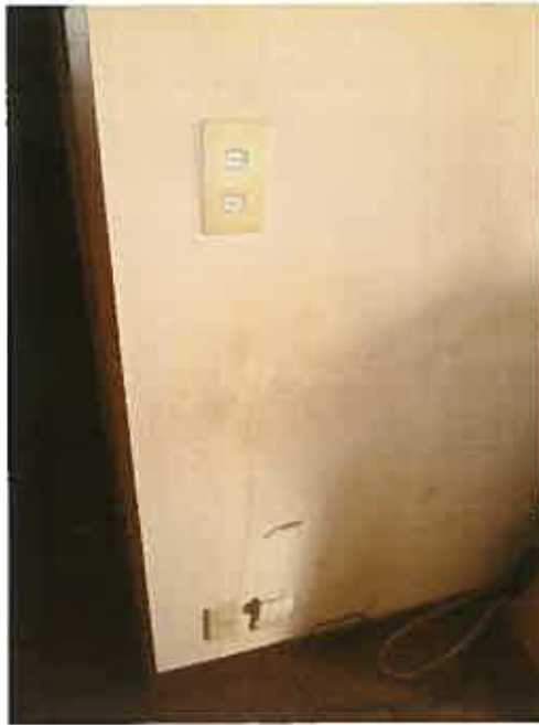
7 同上 壁の汚れ と傷
