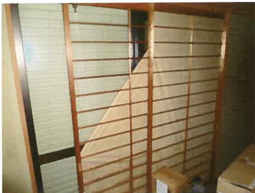
10 同上 障子の 破れ
