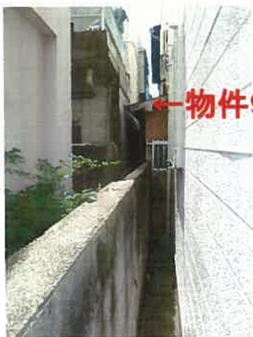
22 同上 庇が隣家にはみ出している状況
