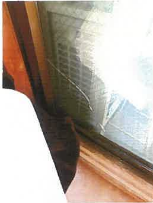
16 同上 ガラスの 破損
