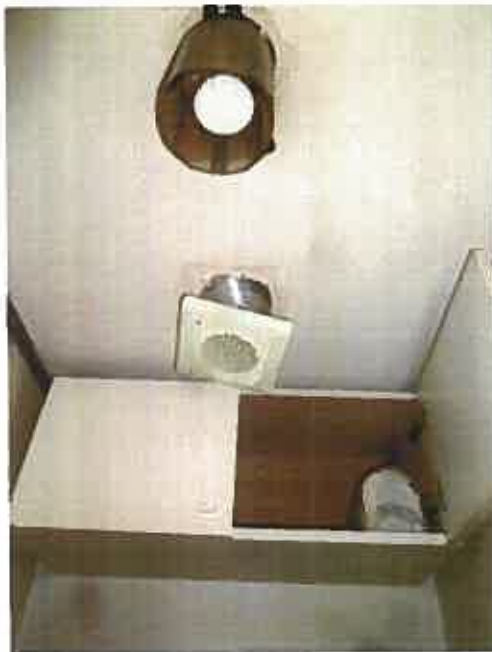
8 トイレ天井 の換気扇
