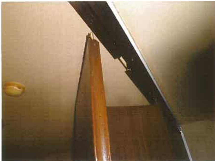
9 同上 仕切り版 が外れて いる状態
