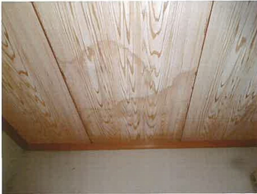
11 同上 雨漏り跡
