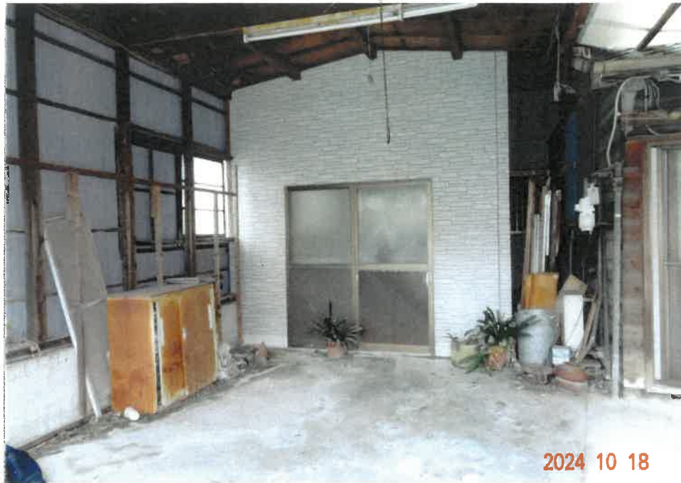
⑦ 物件3建物主である建物1階洋室(増築部分)の状況
