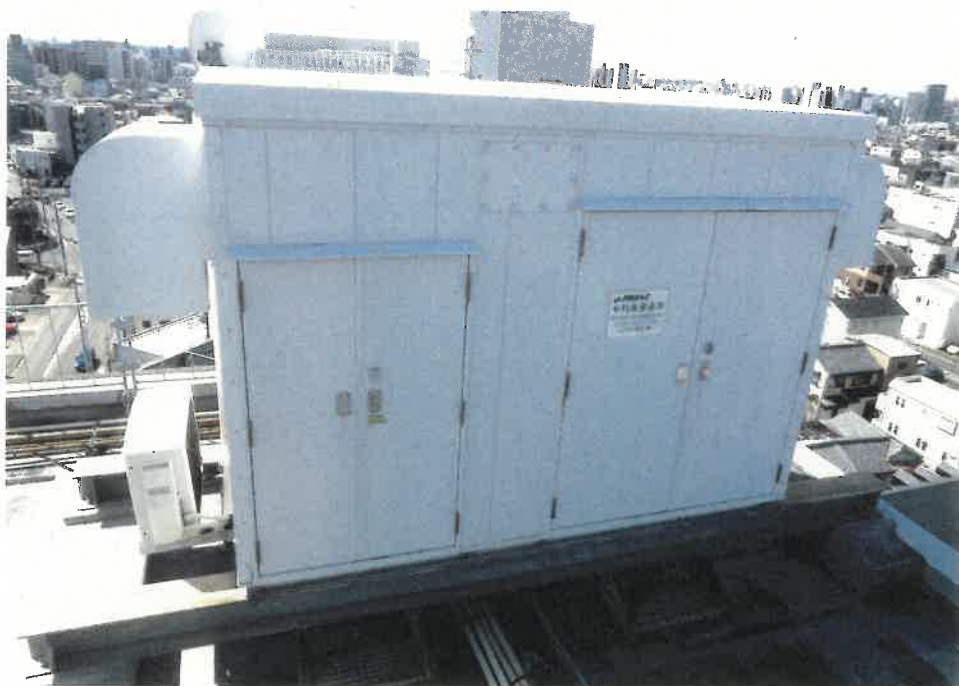
⑫ 屋上の設備の様子
