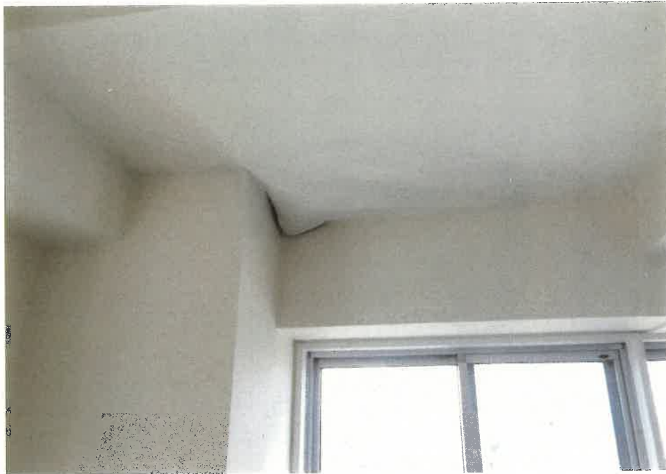
⑦ 屋内の状況（1102号室洋室の雨漏りの様子）
