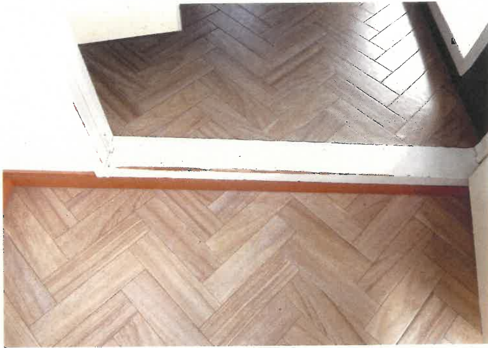
⑤ 屋内の状況（701号室リビング・ダイニング・キッチンの入口の木枠の傷の様子）
