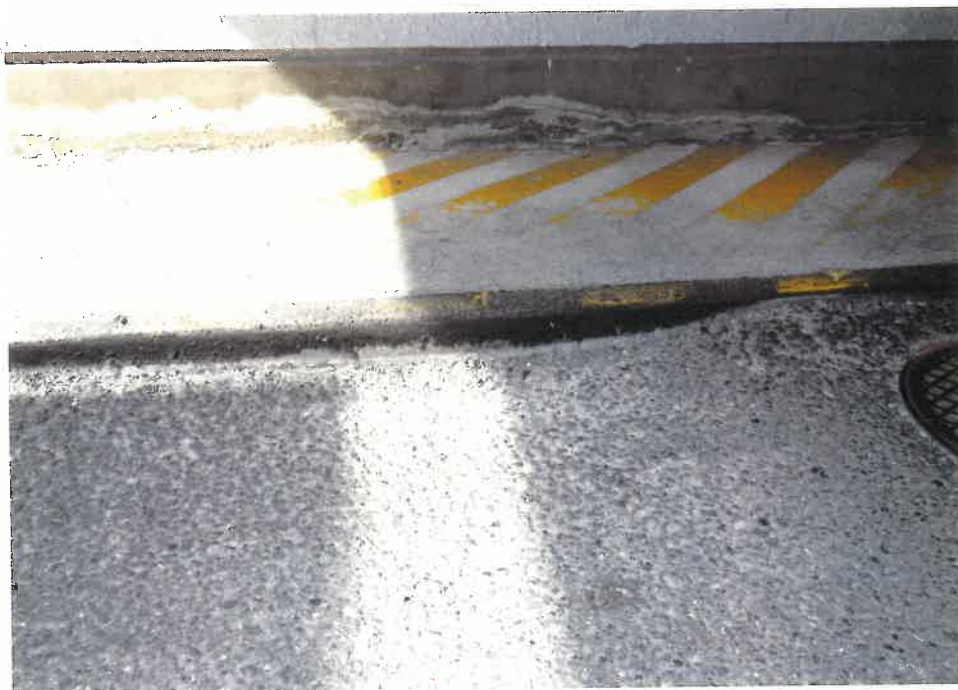
沈んでいる部分
