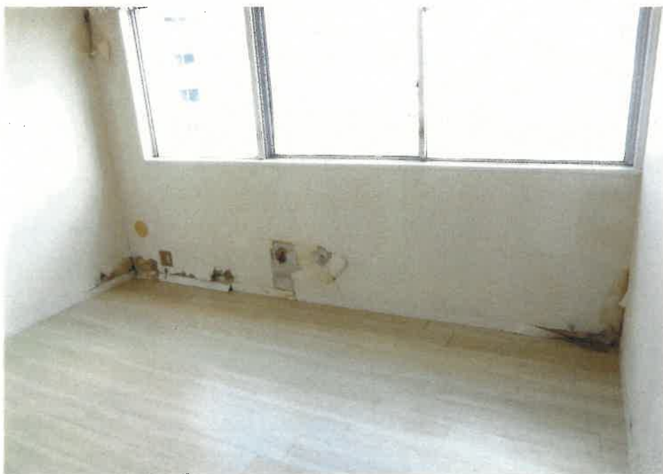
⑧ 屋内の状況（1101号室北側洋室の壁に穴が開いている様子）
