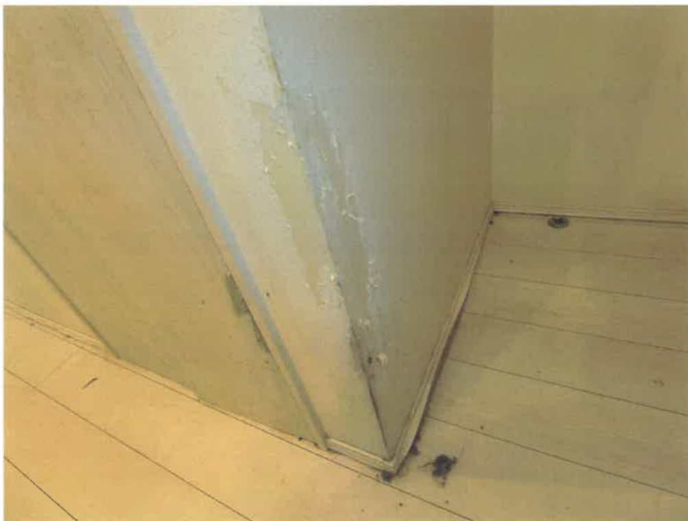
8 物件2建物内部の状況（クロスの損傷・K（キッチン）西側）
