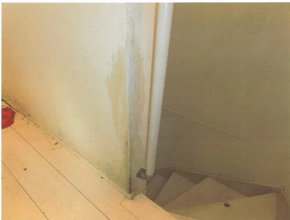
7 物件2建物内部の状況（クロスの損傷・2階廊下）
