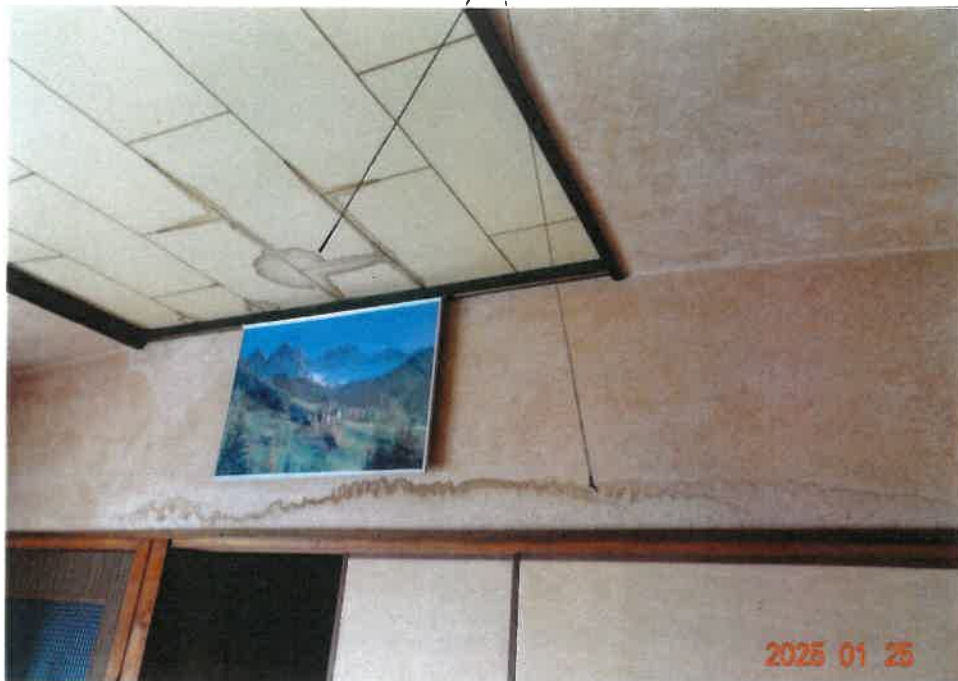
⑪ 物件3建物主である建物の屋内の状況（1階 洋室1の北西側天井の雨漏り跡）
