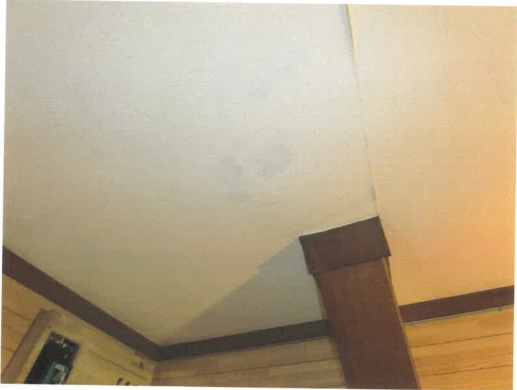
1 1 物件 2 建物内部の状況（雨漏り箇所・廊下天井）
