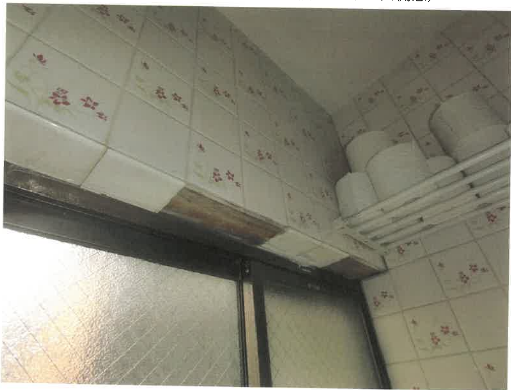
10 物件2建物内部の状況（雨漏り箇所・トイレ西側窓）
