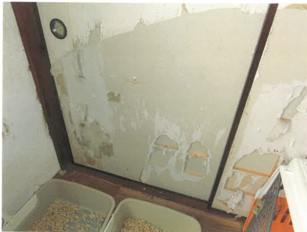
1 4 物件 2 建物内部の状況（建具の損傷・和室（3））
