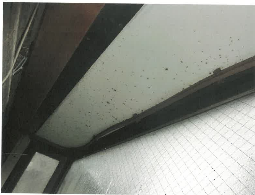
8 物件2建物内部の状況（雨漏り箇所・LD北東側出窓）
