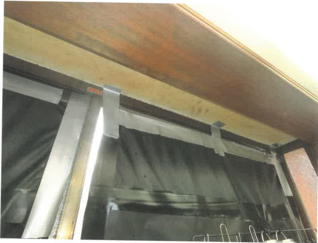
9 物件2建物内部の状況（雨漏り箇所・K西側出窓）
