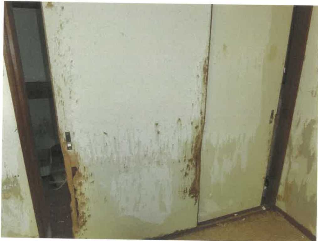
1 2 物件 2 建物内部の状況（建具の損傷・洋室）
