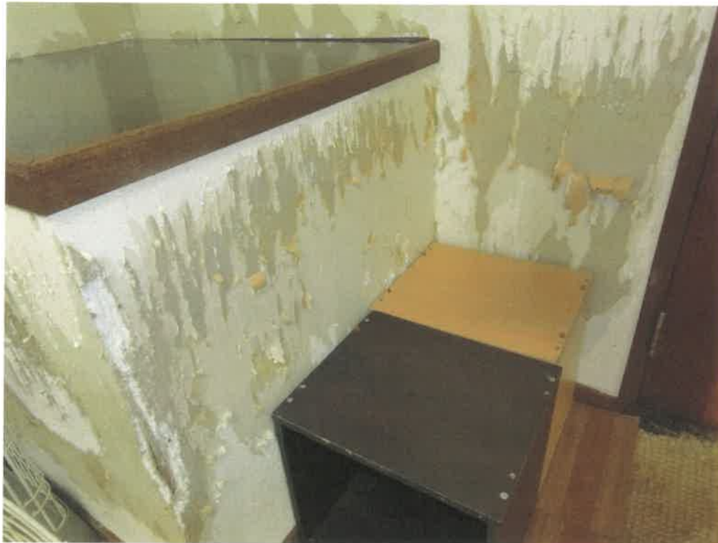
1 3 物件 2 建物内部の状況（壁面の損傷・洋室）
