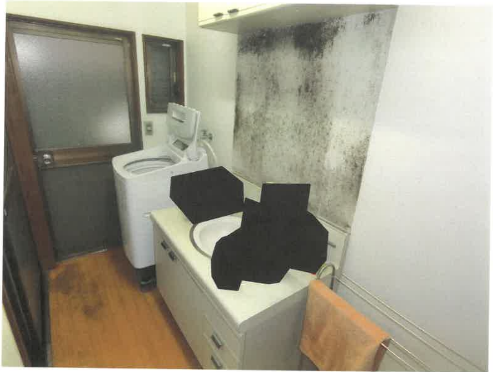
1 5 物件 2 建物内部の状況（壁面の汚損・洗面室）
