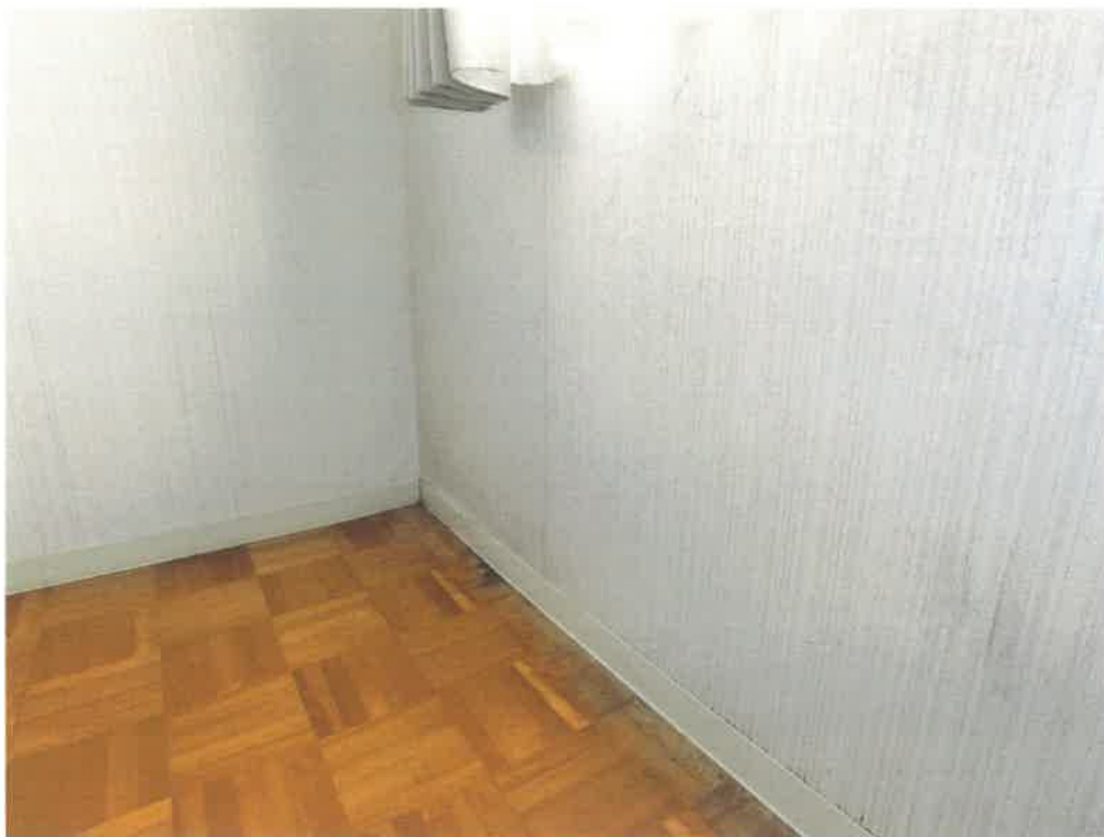
1 2 物件2建物内部の状況（雨漏りによる壁クロスの汚損及び床の劣化（LDK））
