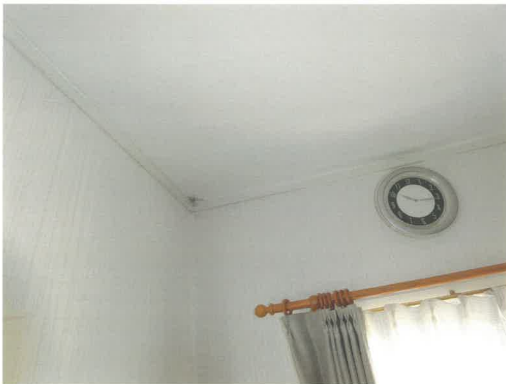
1 1 物件2建物内部の状況（雨漏りによる天井クロスの汚損（LDK））
