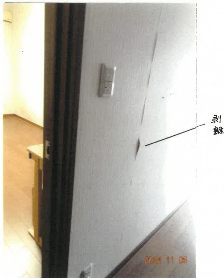
⑥ 屋内の状況（2階廊下の壁のクロスの剥離）
