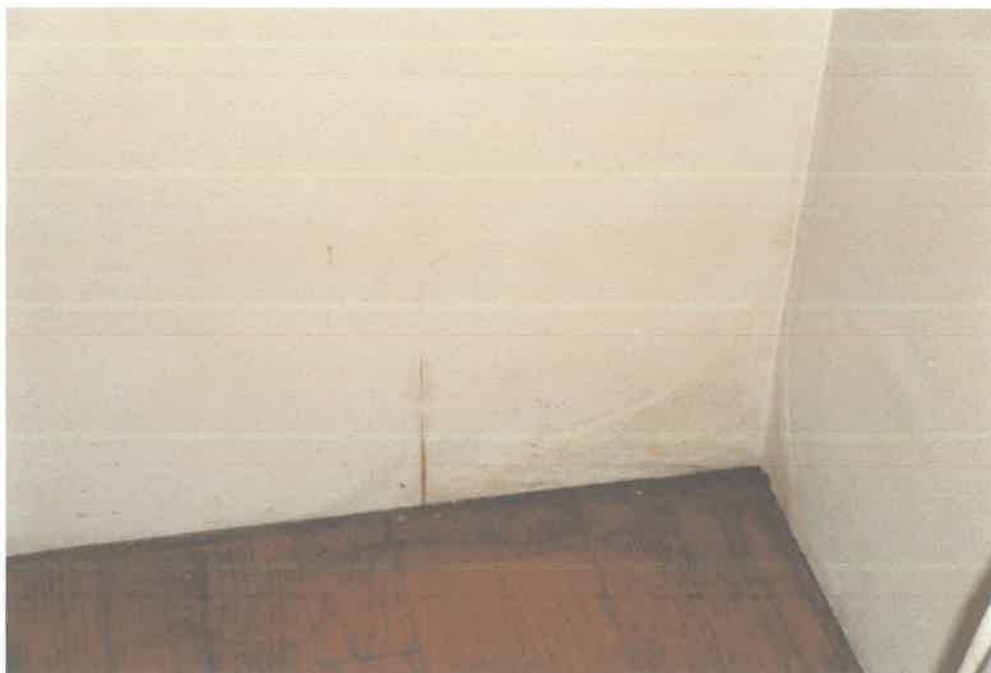
⑧ リビング・ダイニング壁紙の剥がれの状況
