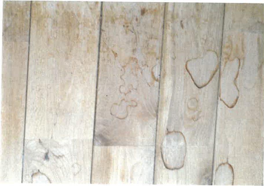
⑦ リビング内のフローリングにあるシミの状況
