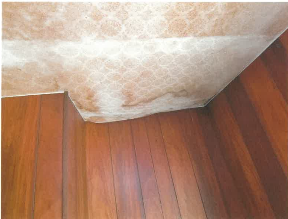
1 5 物件6 建物内部の状況（天井の雨漏り跡・洋室（1））
