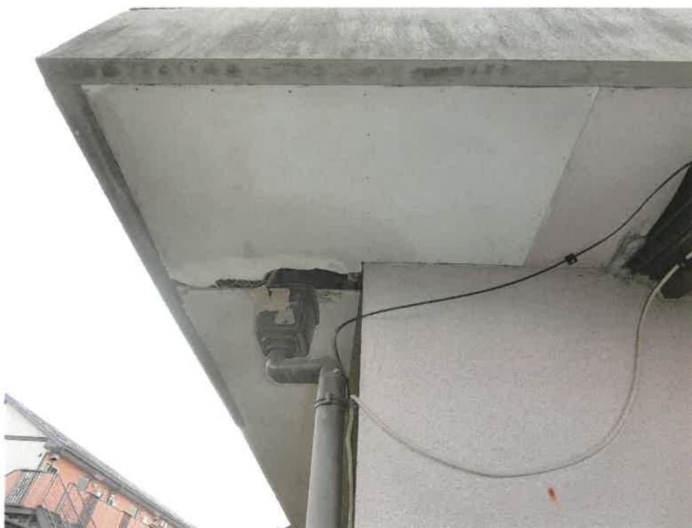
1 8 物件6建物外部の状況（バルコニー下部の損傷）
