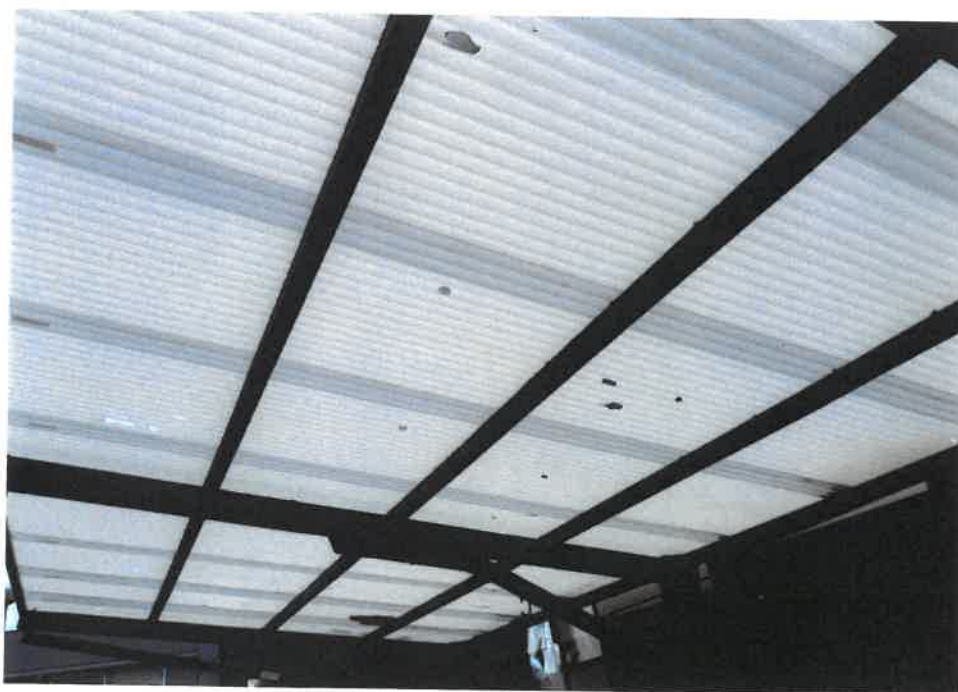
⑩ カーポートのトタン板に穴が開いている様子
