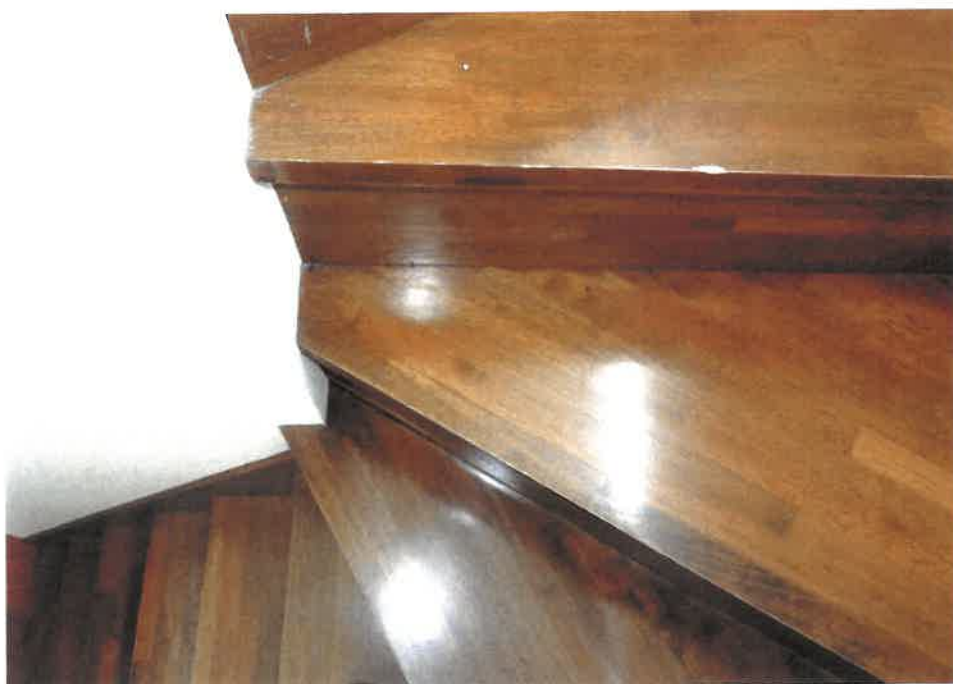
⑥ 屋内の状況（階段の踏面が小さく滑ってしまう箇所の様子）
