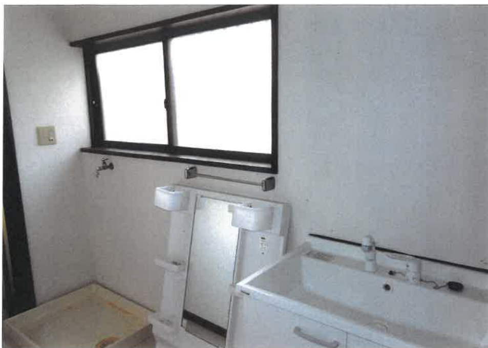
⑦ 屋内の状況（洗面所の鏡面が落下したままになっている様子）
