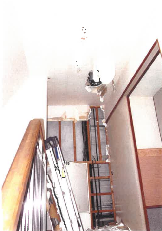
⑨ 壁面等の損傷状況（6階・階段）
