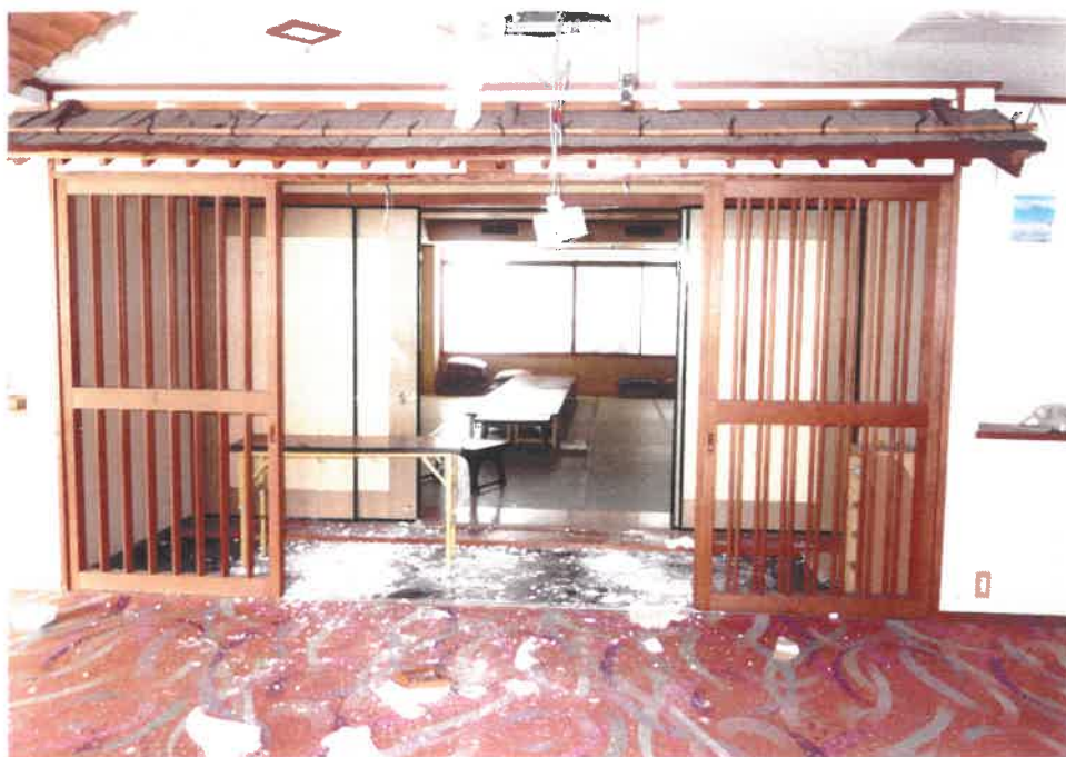
㊤ 天井部の損傷状況（2階・大広間1の東側廊下）
