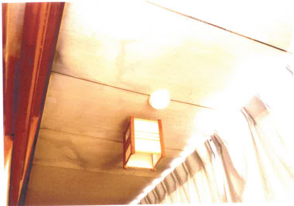
⑪ 天井部の染み（４０６号の居室）
