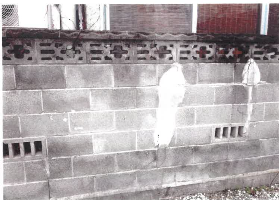
㊵ ブロック塀のひび割れ
