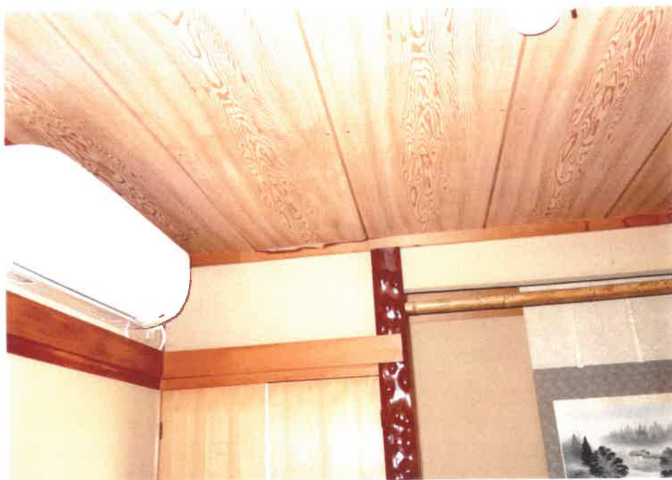
⑬ 天井部の染み及び天井材のふやけ箇所（４０９号）
