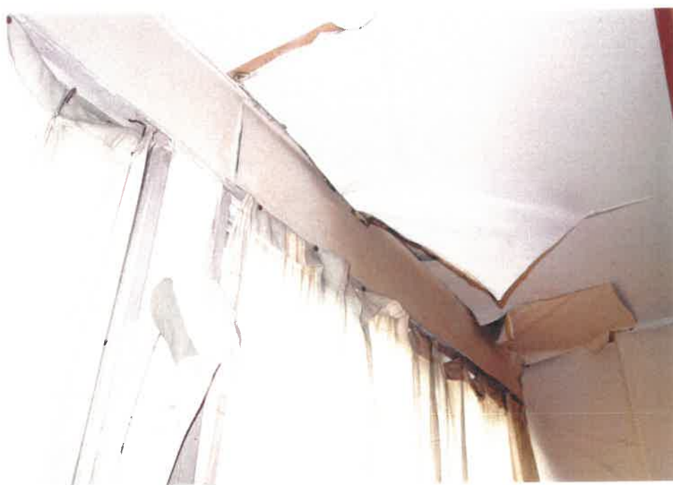
②⑩ 天井材のふやけ箇所（3階・倉庫）
