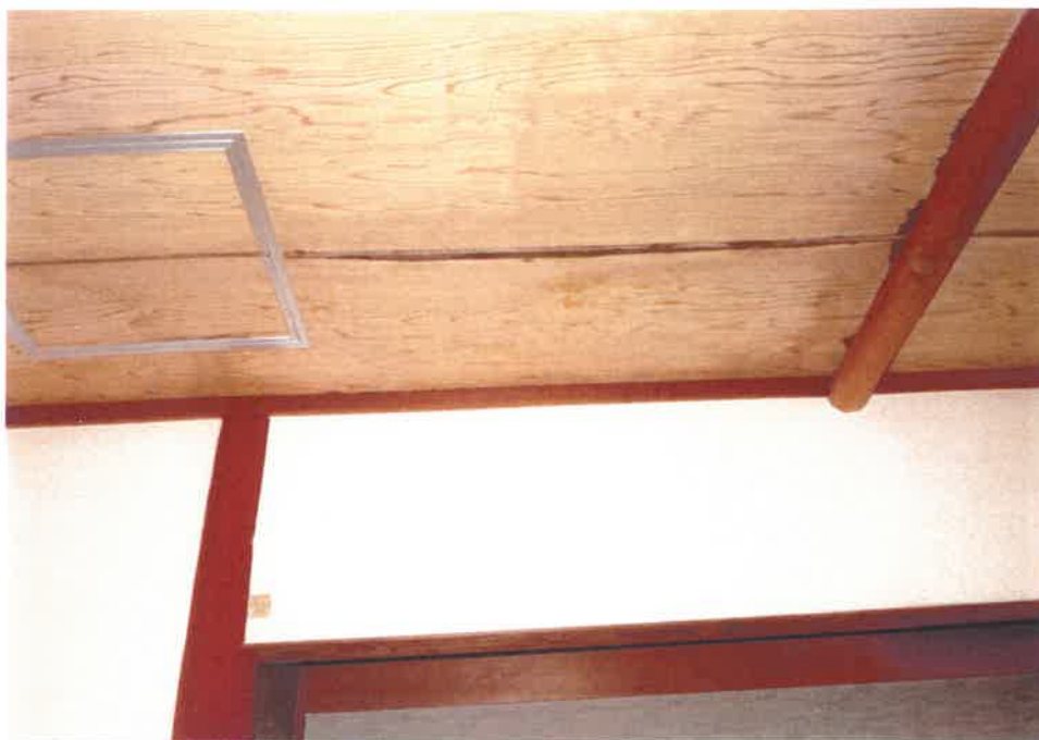
①⑨ 天井部の染み及び天井材のふやけ箇所（304号）
