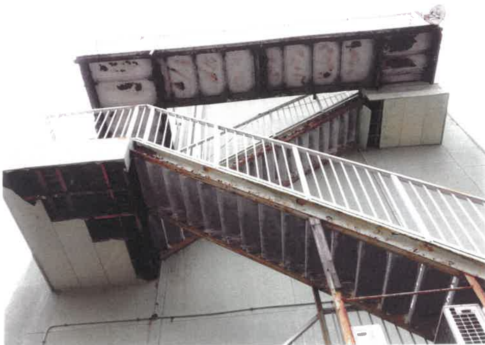
㊸ 外階段の腐食、破損等
