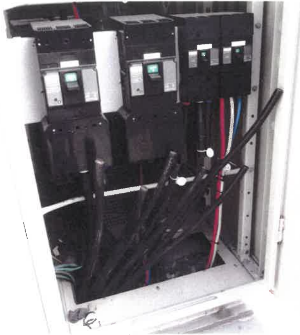
⑦ 配線の切断状況（7階・変電設備）
