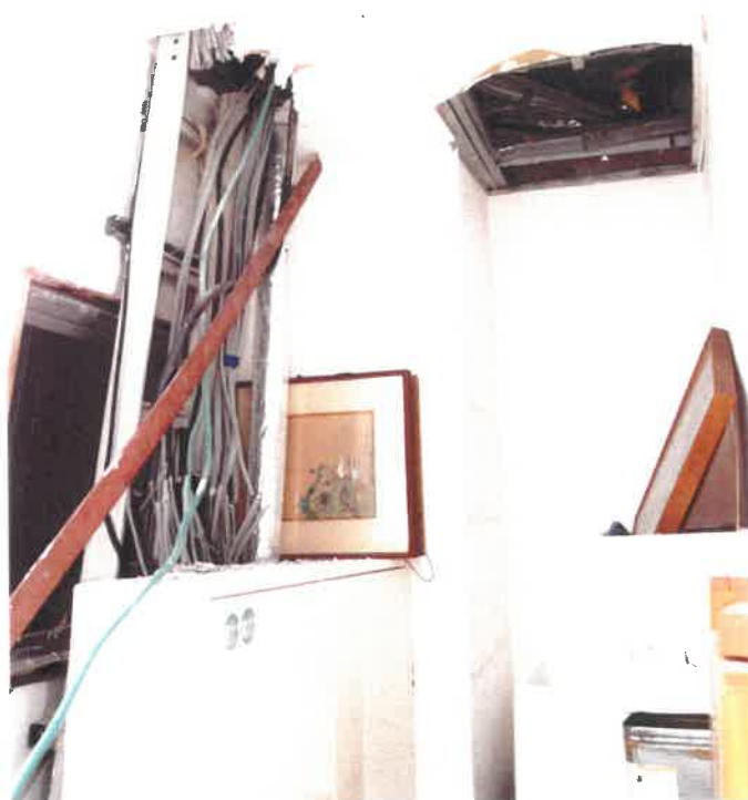
⑯ 壁面等の損傷状況（４階・PS（パイプスペース））
