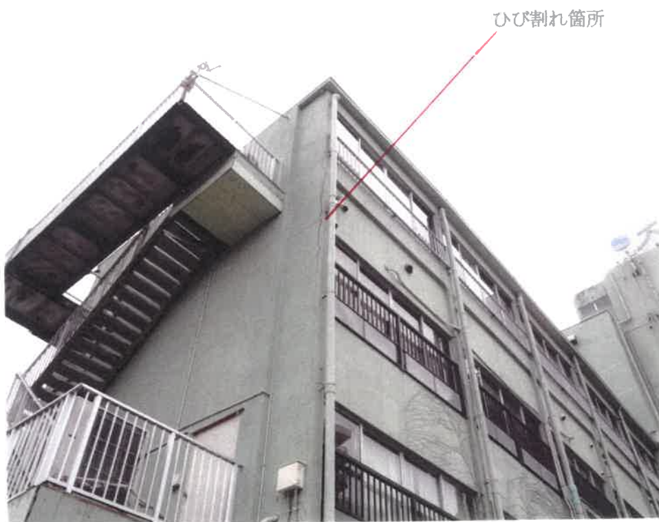
㊹ 外壁のひび割れ
