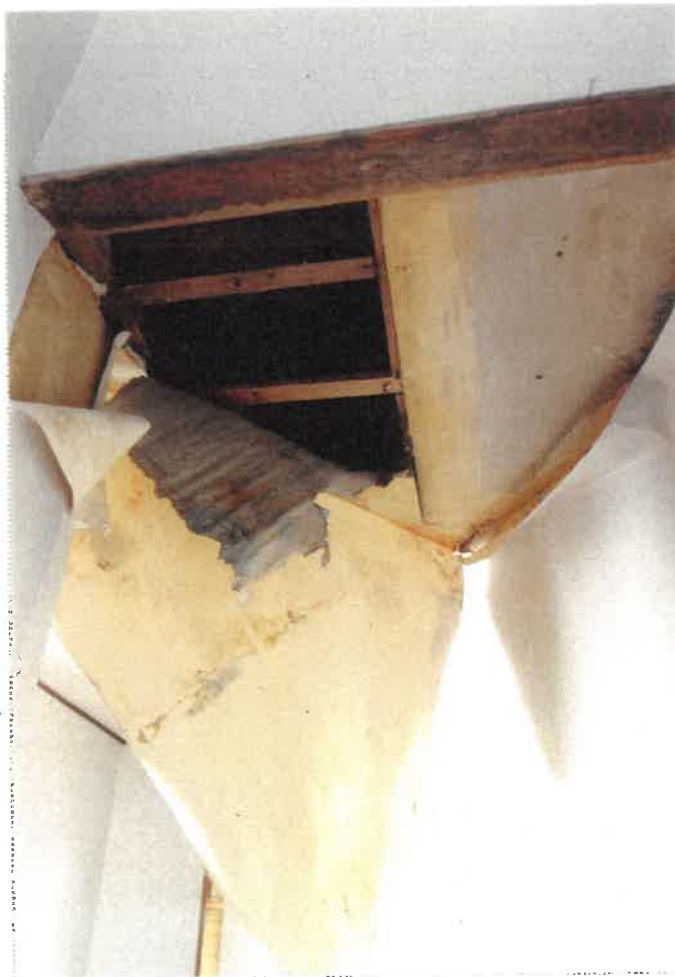
⑩ 雨漏り跡の状況（3階階段付近）
