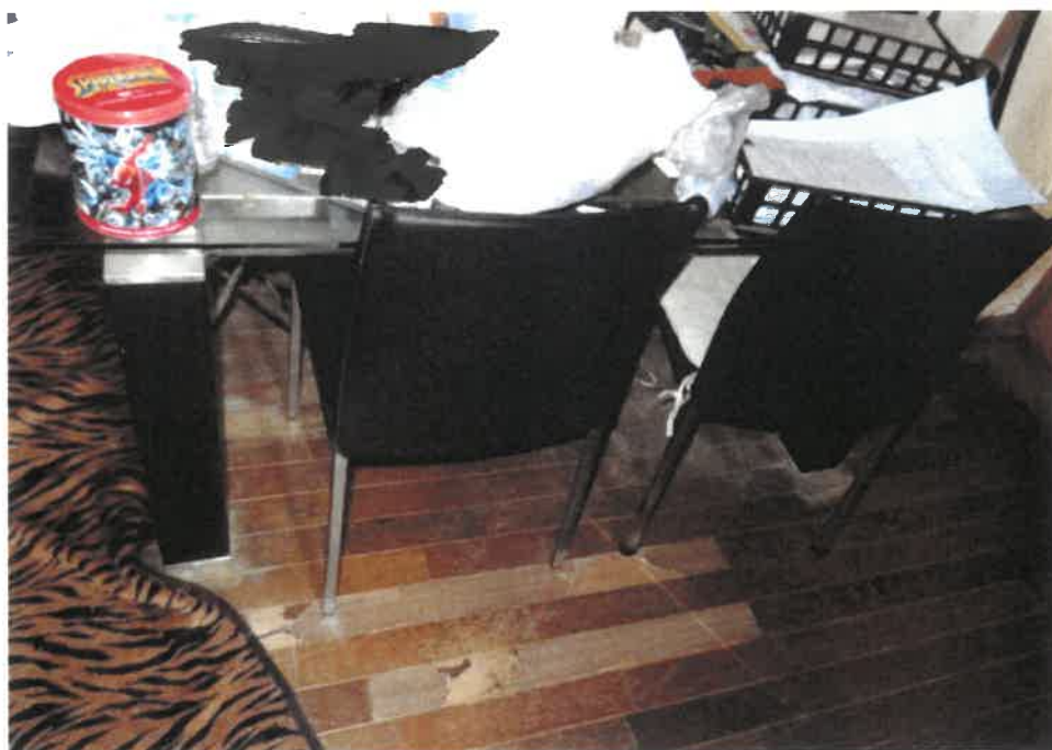
⑥ 屋内の状況（リビングダイニングの床が傷んでいる様子）
