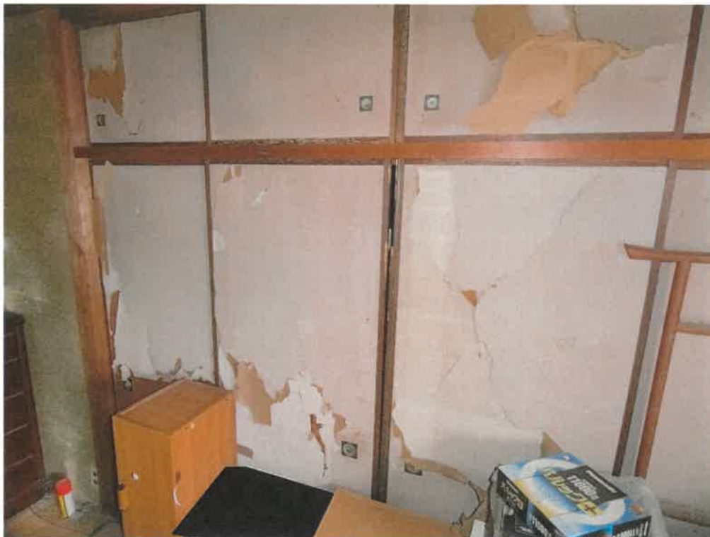
1 6 物件6 建物内部の状況（建具の損傷・和室（1））
