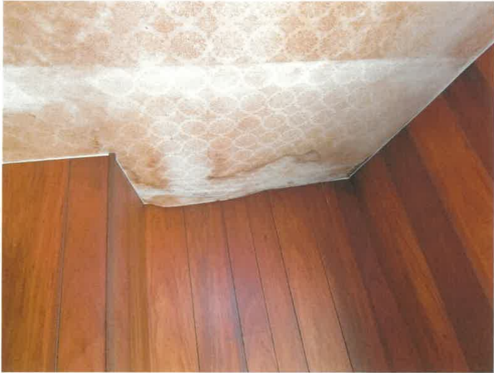
1 5 物件6 建物内部の状況（天井の雨漏り跡・洋室（1））
