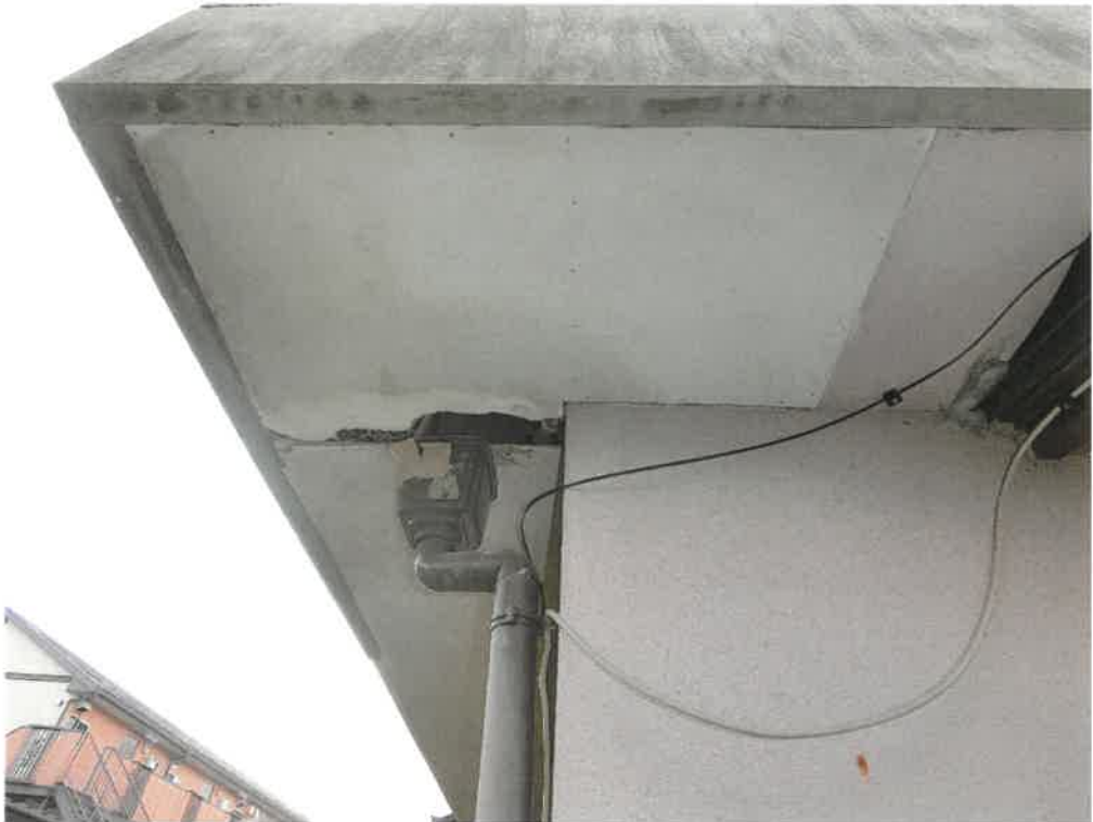
1 8 物件 6 建物外部の状況（バルコニー下部の損傷）
