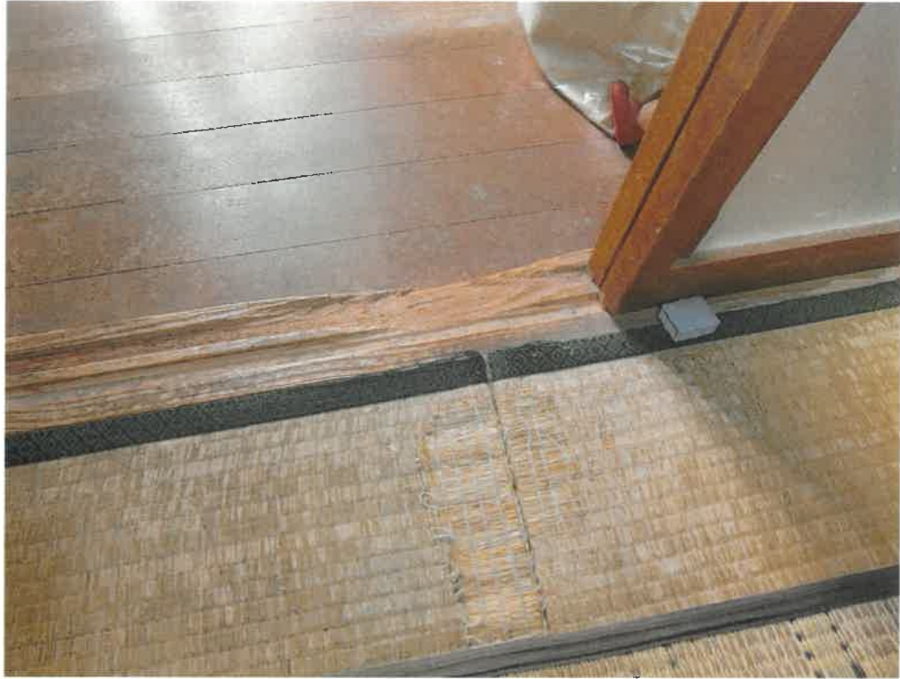
1 7 物件 6 建物内部の状況（敷居の損傷・和室（2））
