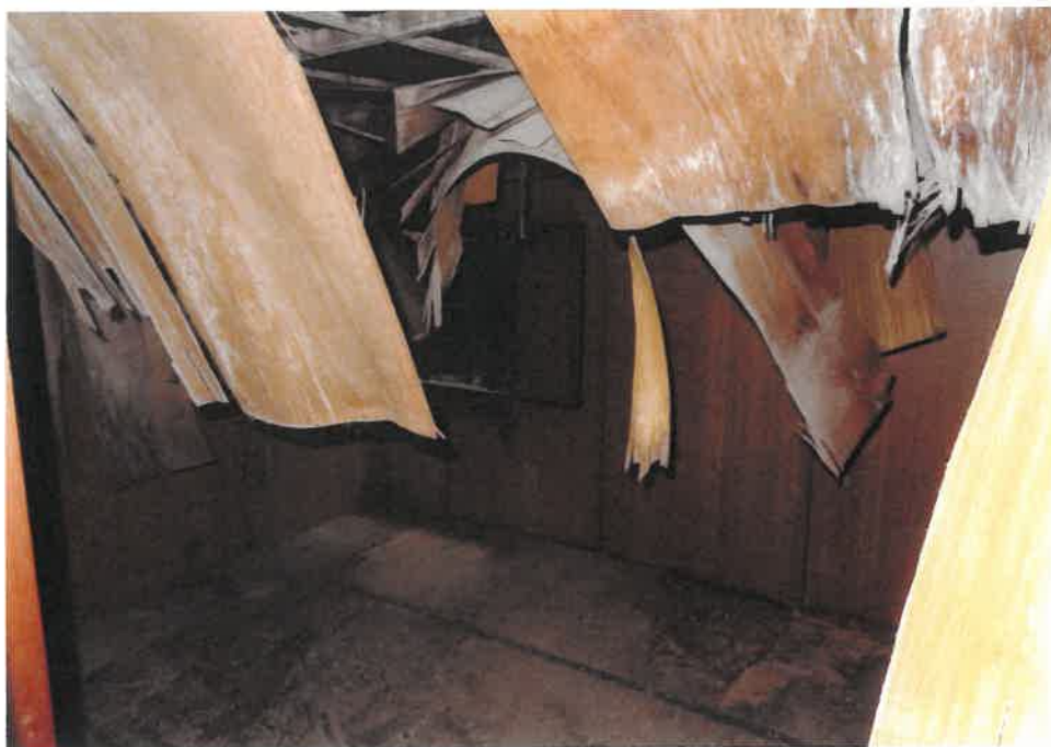
⑦ 屋内の状況（和室4.5畳2の天井部分の様子）
