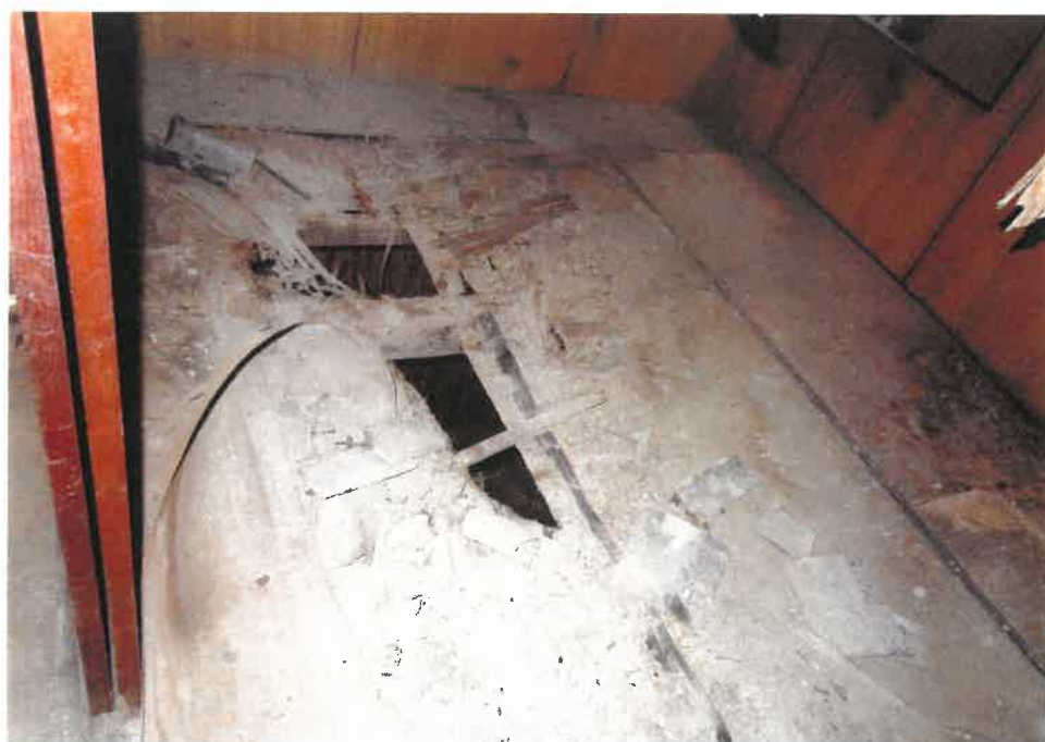
⑥ 屋内の状況（和室4.5畳2の床に穴が開いている様子）
