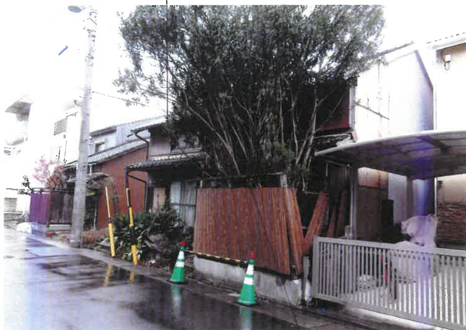
① 北西方向から撮影（外壁の壁板が剥がれている様子）
