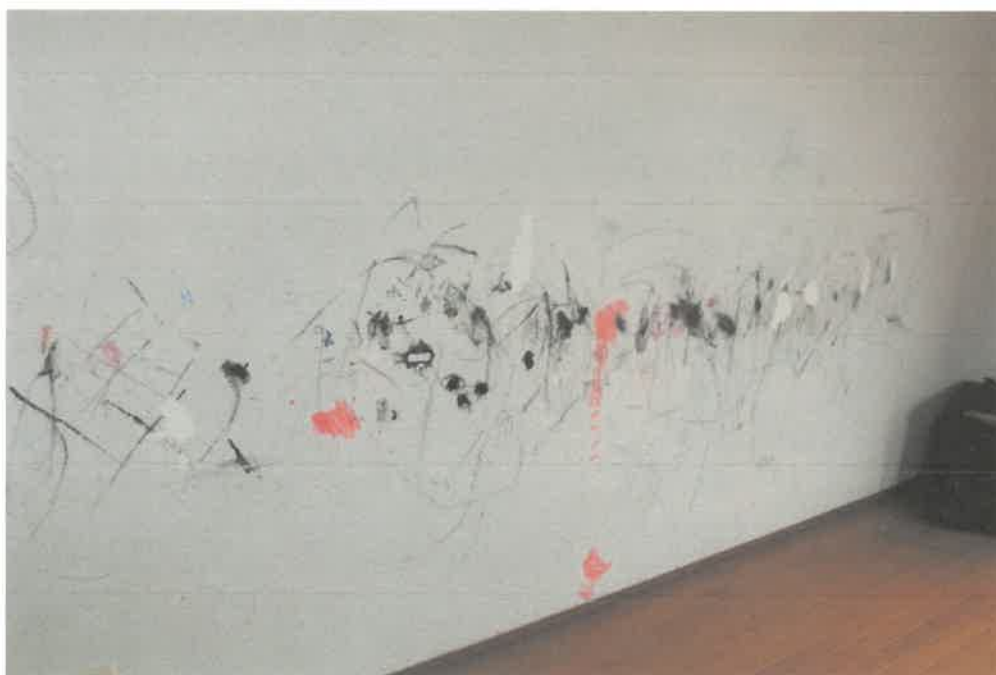
⑧ 洋室1 壁紙への落書きの状況
