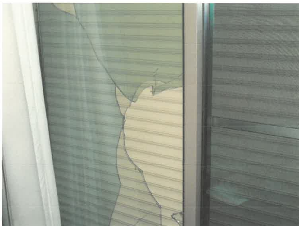
④ リビング・ダイニング北側のガラスが割れている状況
