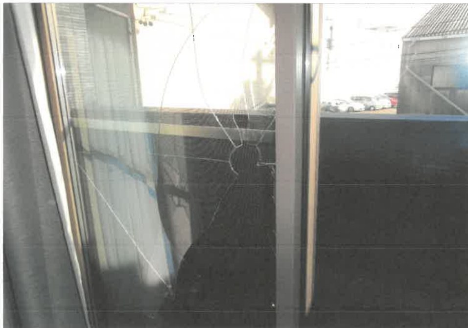
⑥ 洋室1 南側のガラスが割れている状況
