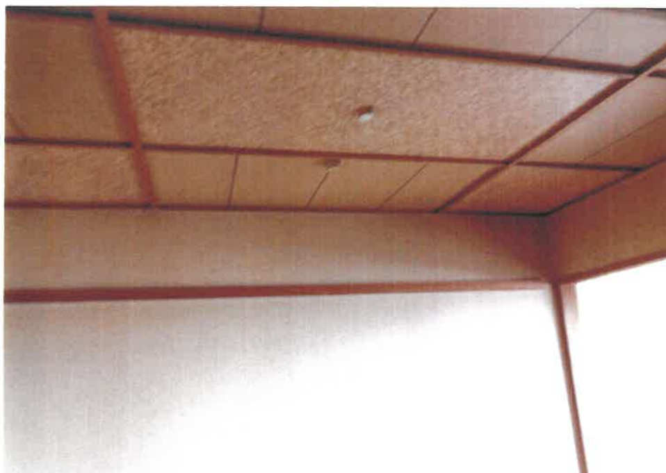
④ 屋内の状況（和室の天井板が剥がれている様子）
