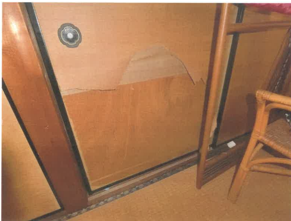
9 物件1主である建物内部の状況（建具の損傷（和室1））
