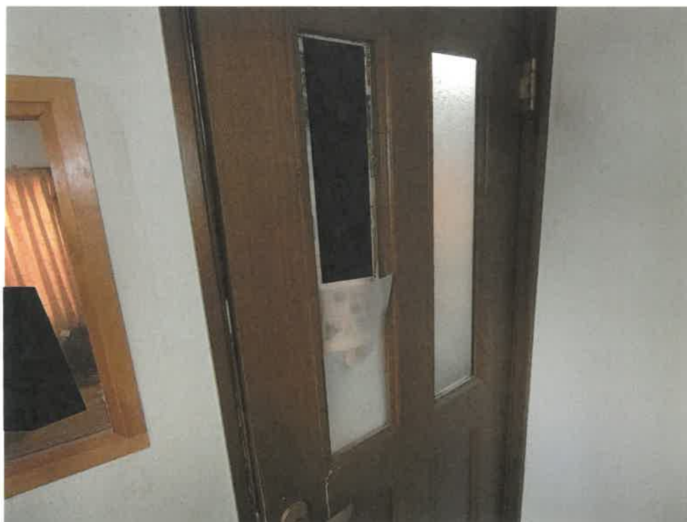
7 物件3建物内部の状況（ドアガラスの損傷（リビング入口））
