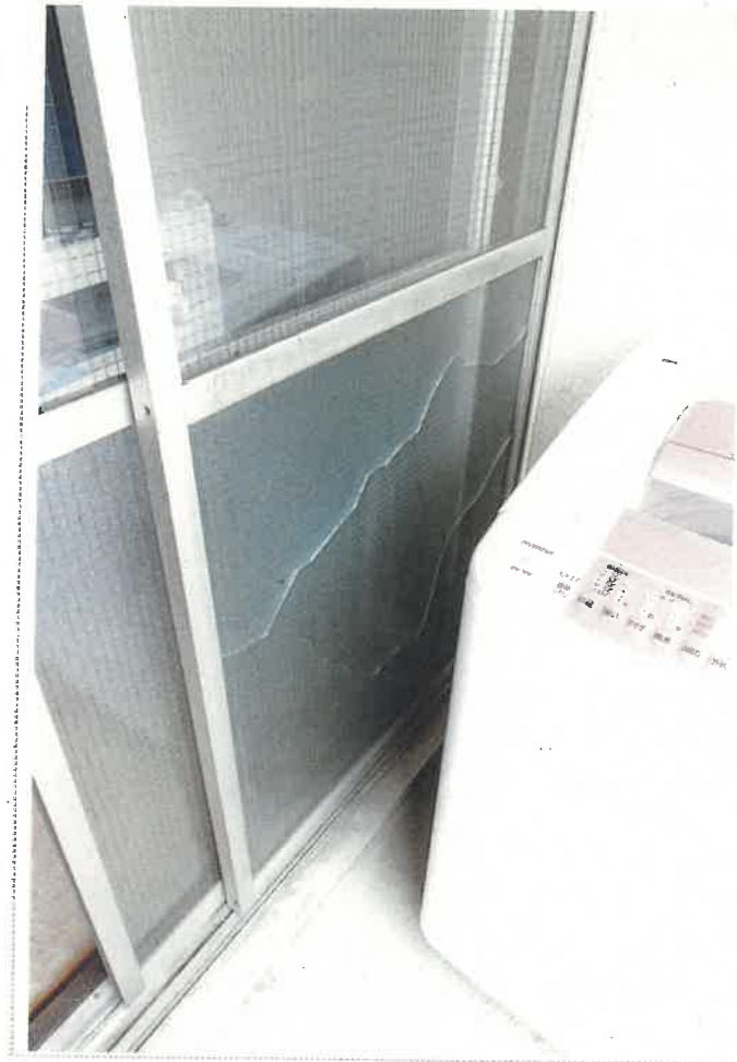
9 窓ガラスのひび割れの状況（和室（205号室））
