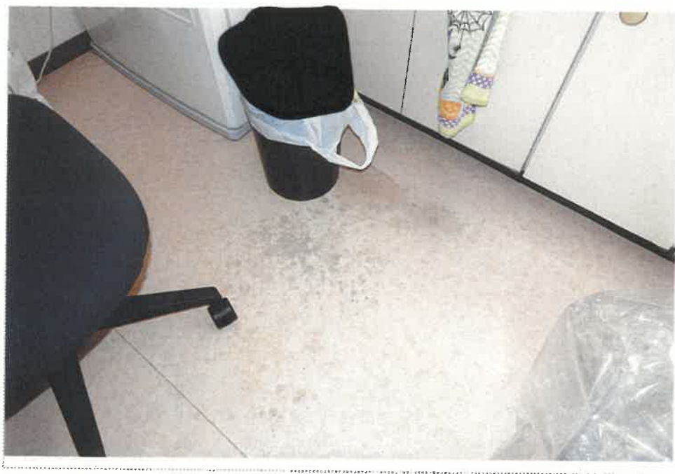
10 床面の変色状況（リビング・ダイニング・キッチン（302号室））
