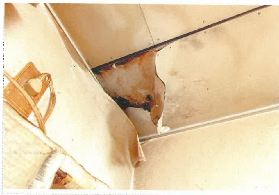
8 水漏れ跡の状況（リビング・ダイニング・キッチン（202号室））
