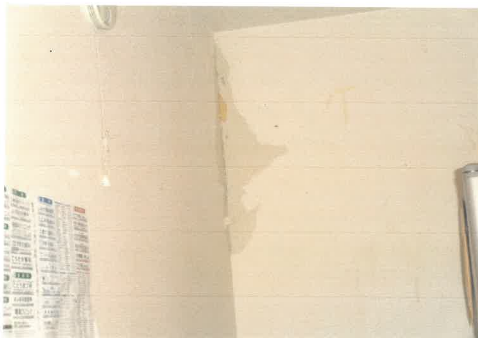
⑦ キッチン壁紙が剥がれた状況
