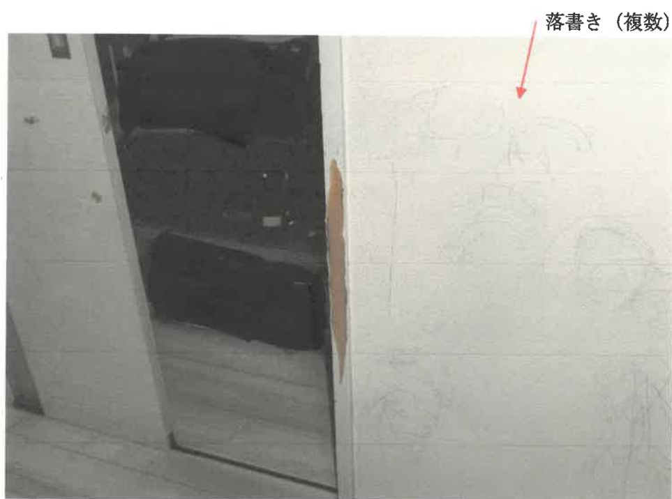
⑧ リビングの壁紙の剥がれ、落書きの状況
