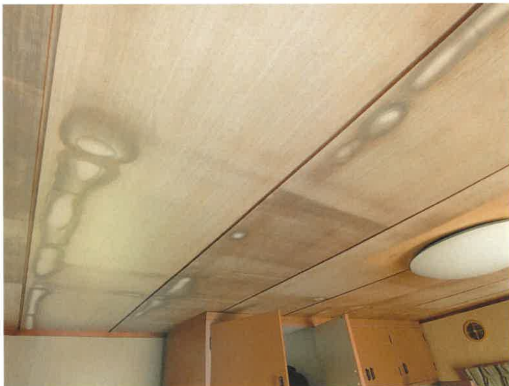
10 物件4建物内部の状況（天井の染み・洋室（2））
