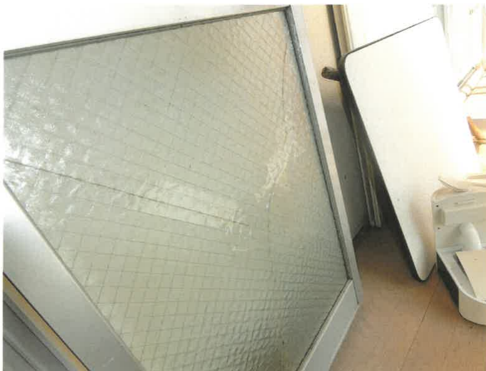
1 1 物件4建物内部の状況（窓ガラスの損傷・2階サニールーム）
