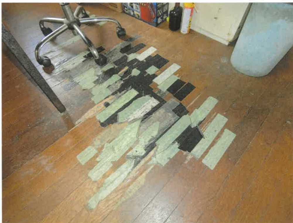
1 2 物件4建物内部の状況（床面の損傷・DK）
