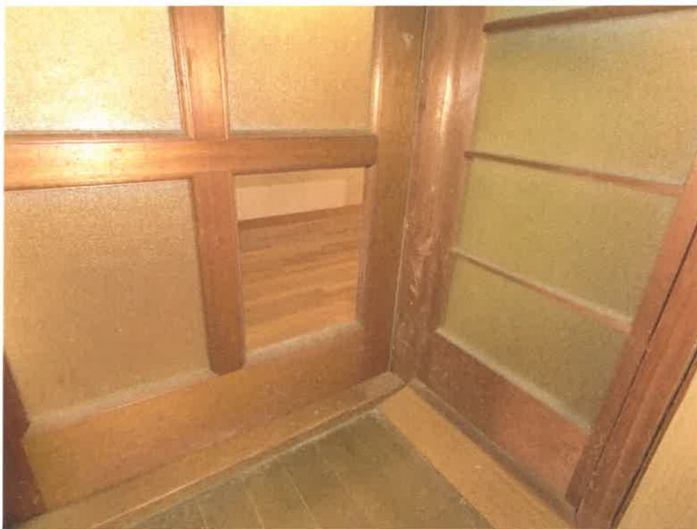
7 物件2建物内部の状況（ドアガラスの欠損・LD）
