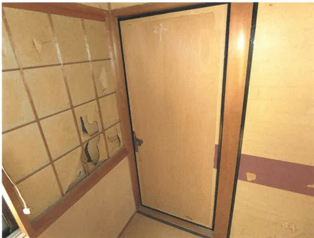
8 物件2建物内部の状況（建具の損傷・和室（2））
