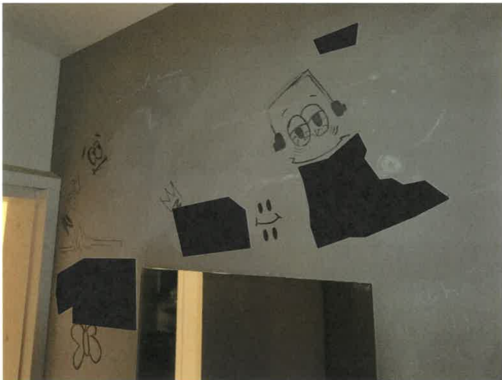
8 物件2建物内部の状況（クロスの汚損（洋室3））
