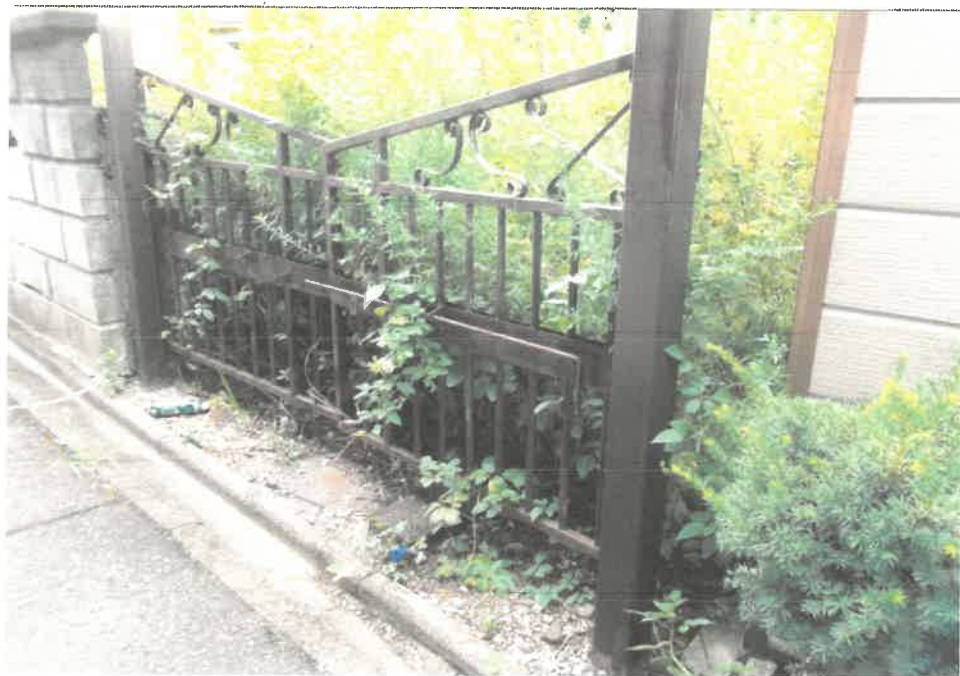
⑮ 物件3土地門扉の状況
