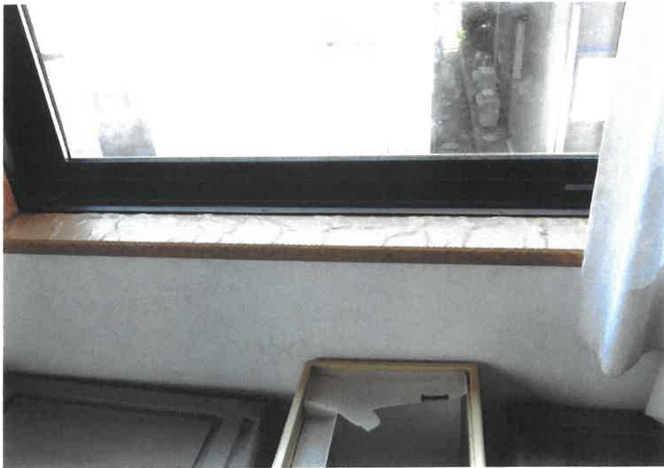
⑦ 屋内の状況（洋室②窓の幅木が猫の尿により波打っている様子）
