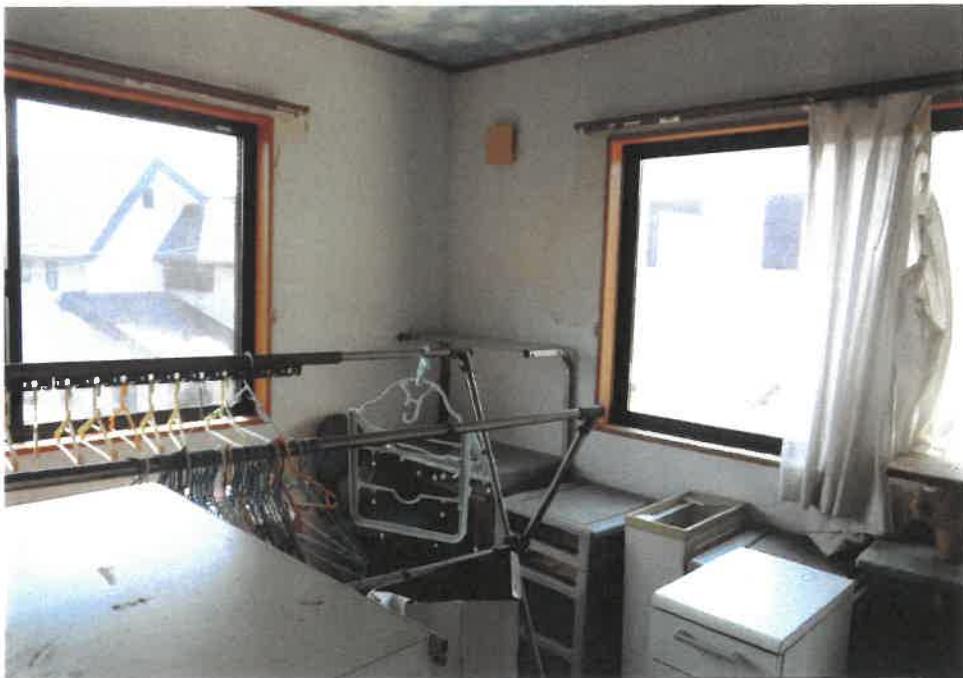
⑥ 屋内の状況（洋室②壁紙が剥がれている様子）
