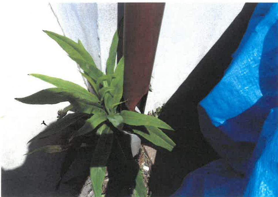
⑧ 屋内の状況（雨樋が割れている様子）
