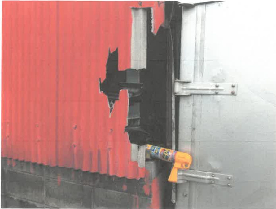
⑦ 物件2建物のスレート破損の状況
