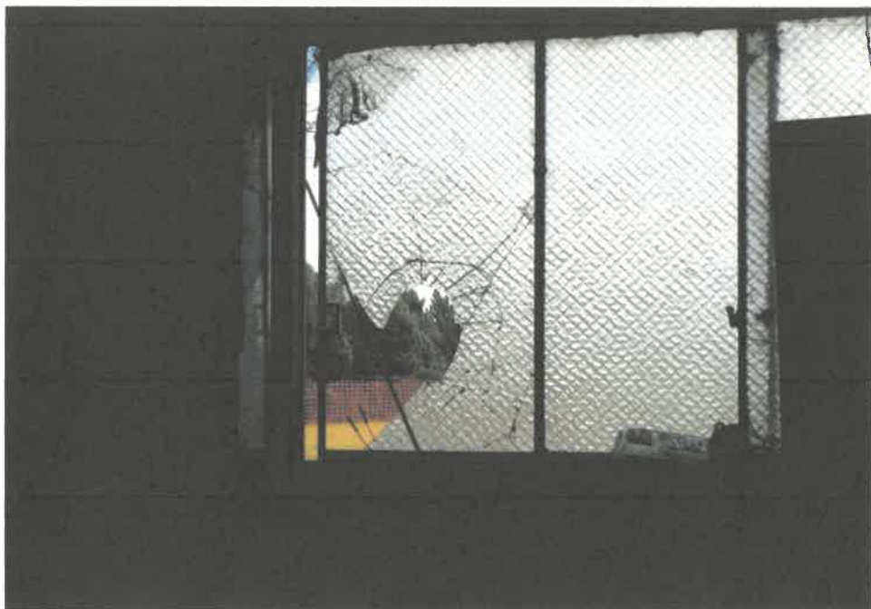
⑥ 物件 2 建物ガラスの破損の状況
