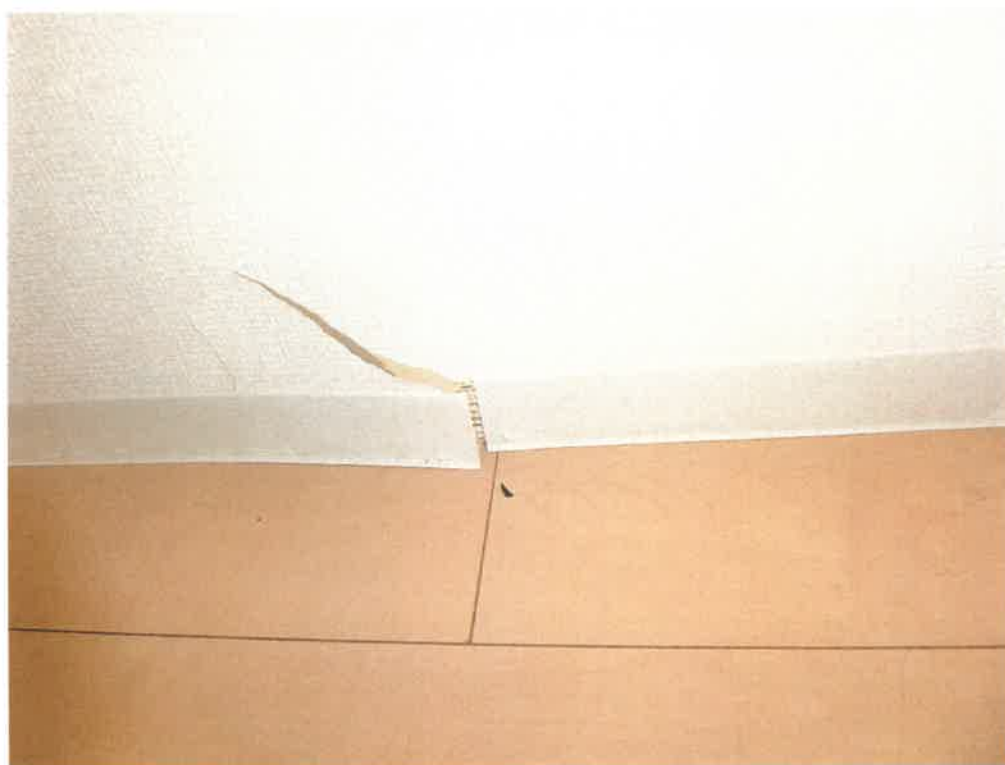
8 物件1 建物内部の状況（壁面の損傷・洋室(1)）
