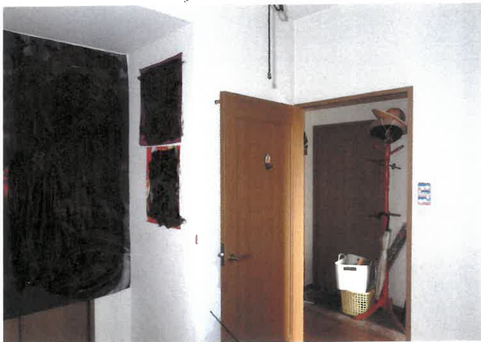
クロスが剥がれている様子 ⑤ 屋内の状況（洋室Cのクロスが剥がれている様子）
