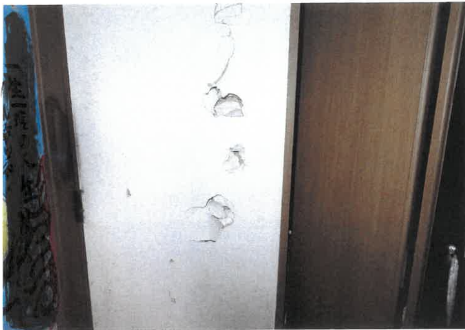
⑦ 屋内の状況（洋室Bの壁に穴が開いている様子）
