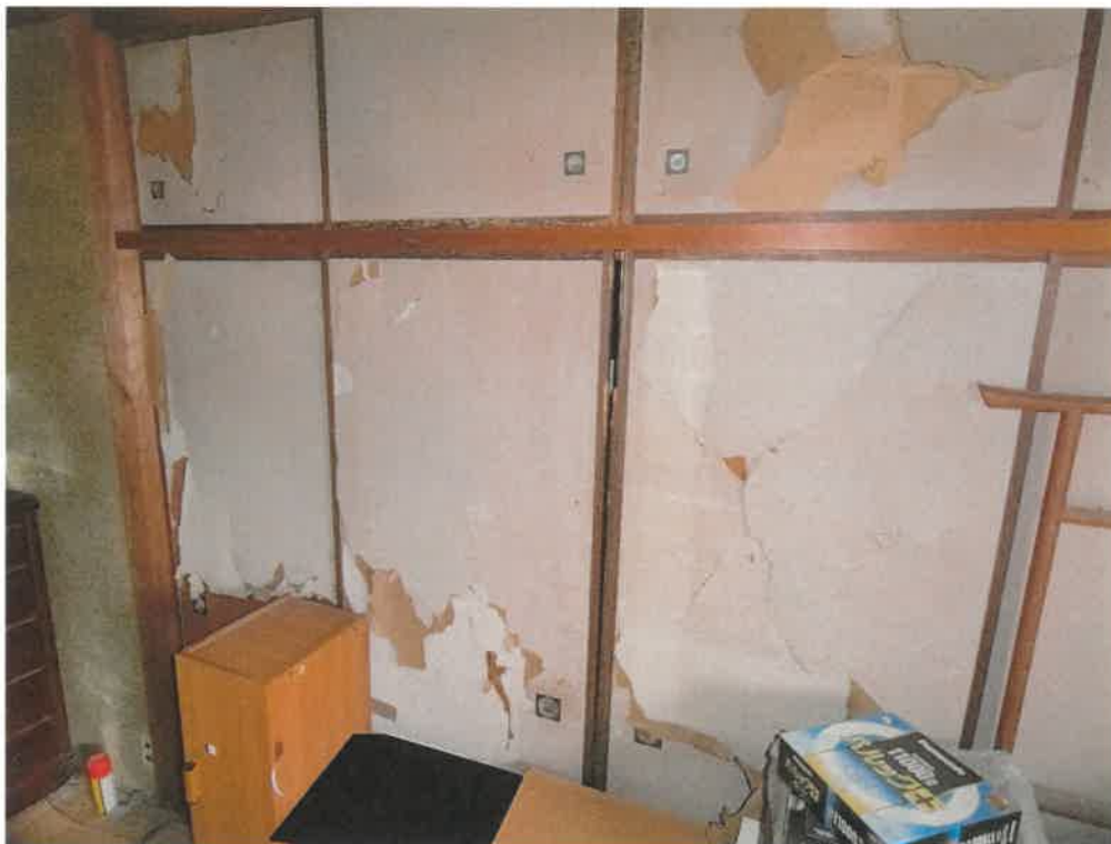
1 6 物件6建物内部の状況（建具の損傷・和室（1））
