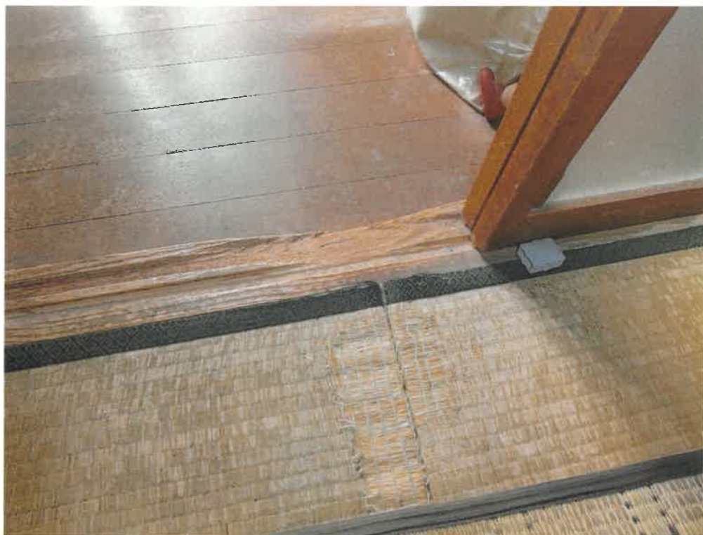
1 7 物件 6 建物内部の状況（敷居の損傷・和室（2））
