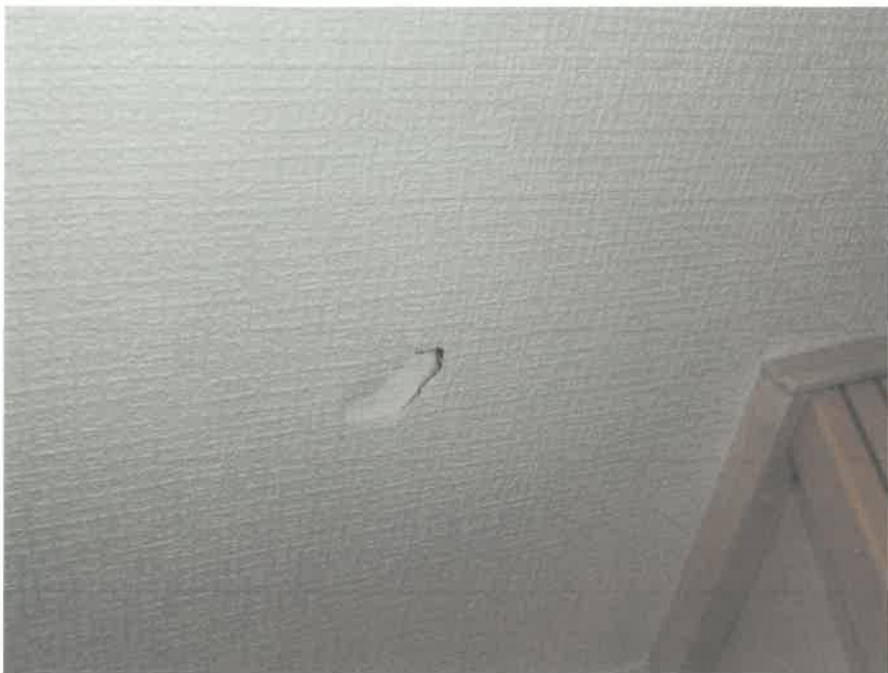
⑧ 階段の壁の穴の状況
