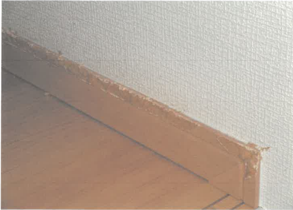
⑦ 2階階段付近の壁下を犬が噛んだ状況
