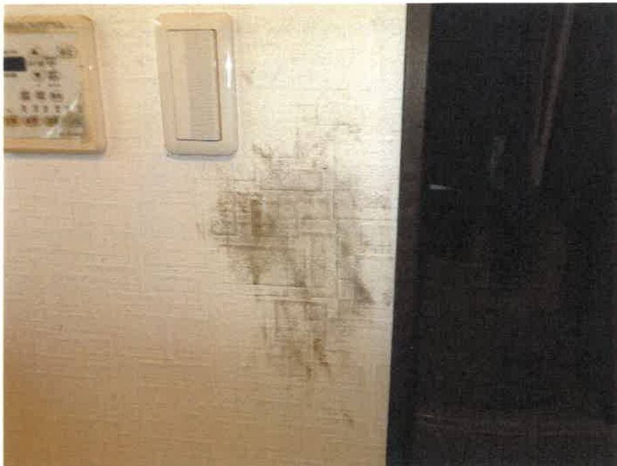
⑧ 洗面室のクロスの状況
