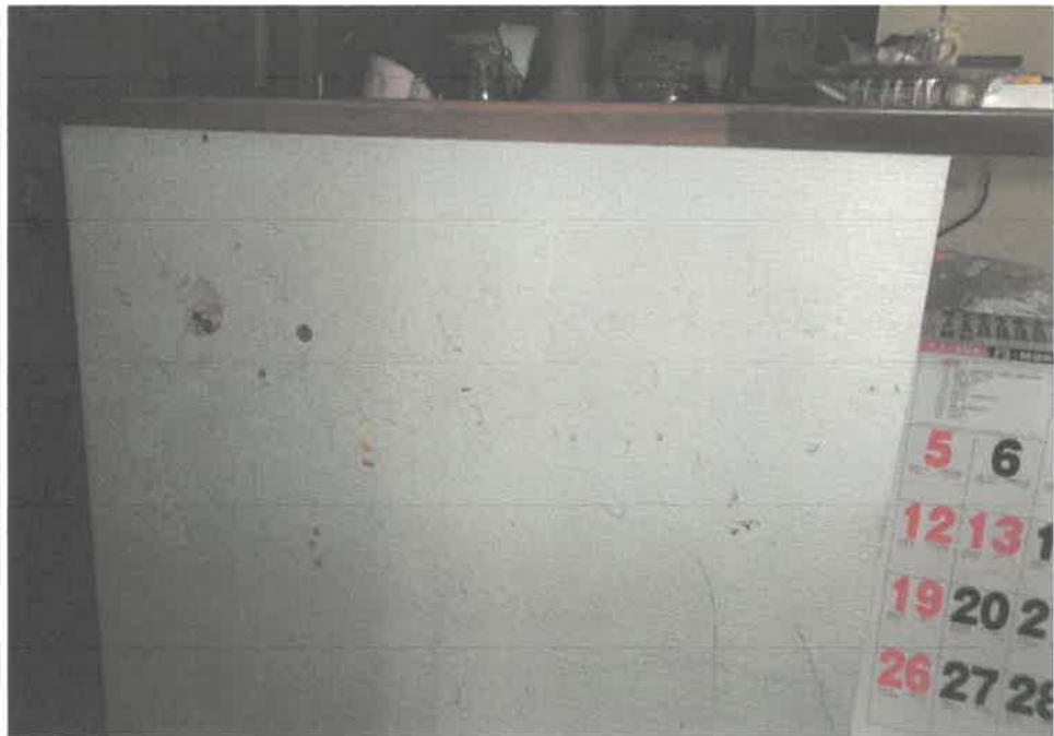
⑧ キッチンカウンター壁の落書きの状況
