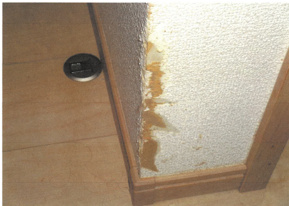
⑧ 洗面室付近の壁紙が剥がれた状況
