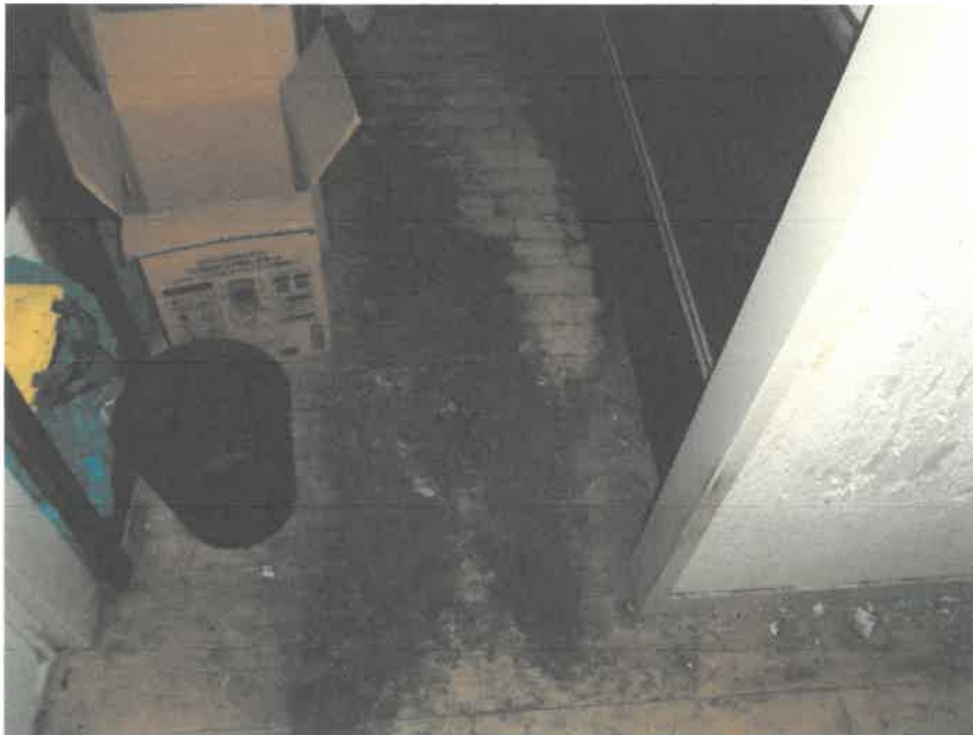
⑧ キッチンの床の状況
