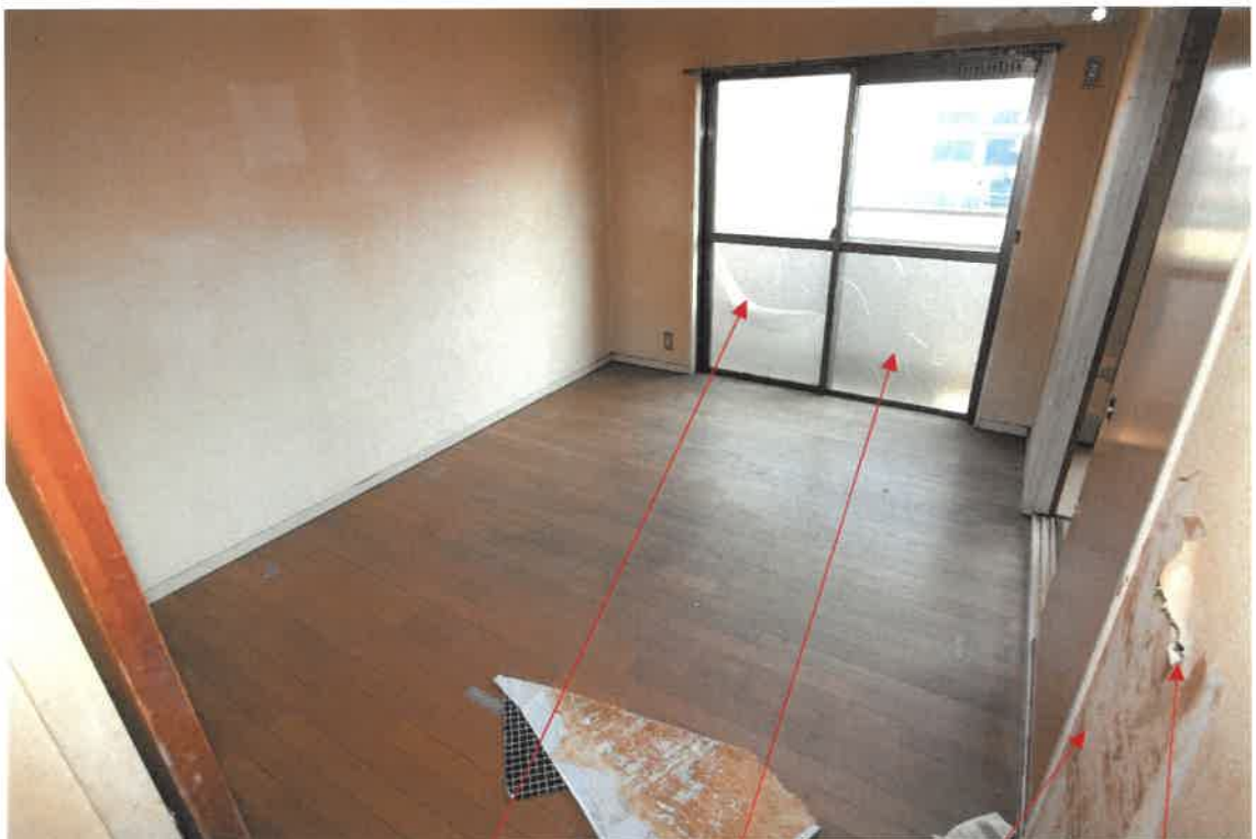
網戸破れ 窓ガラスにひび 壁紙クロスの破れ, 穴
