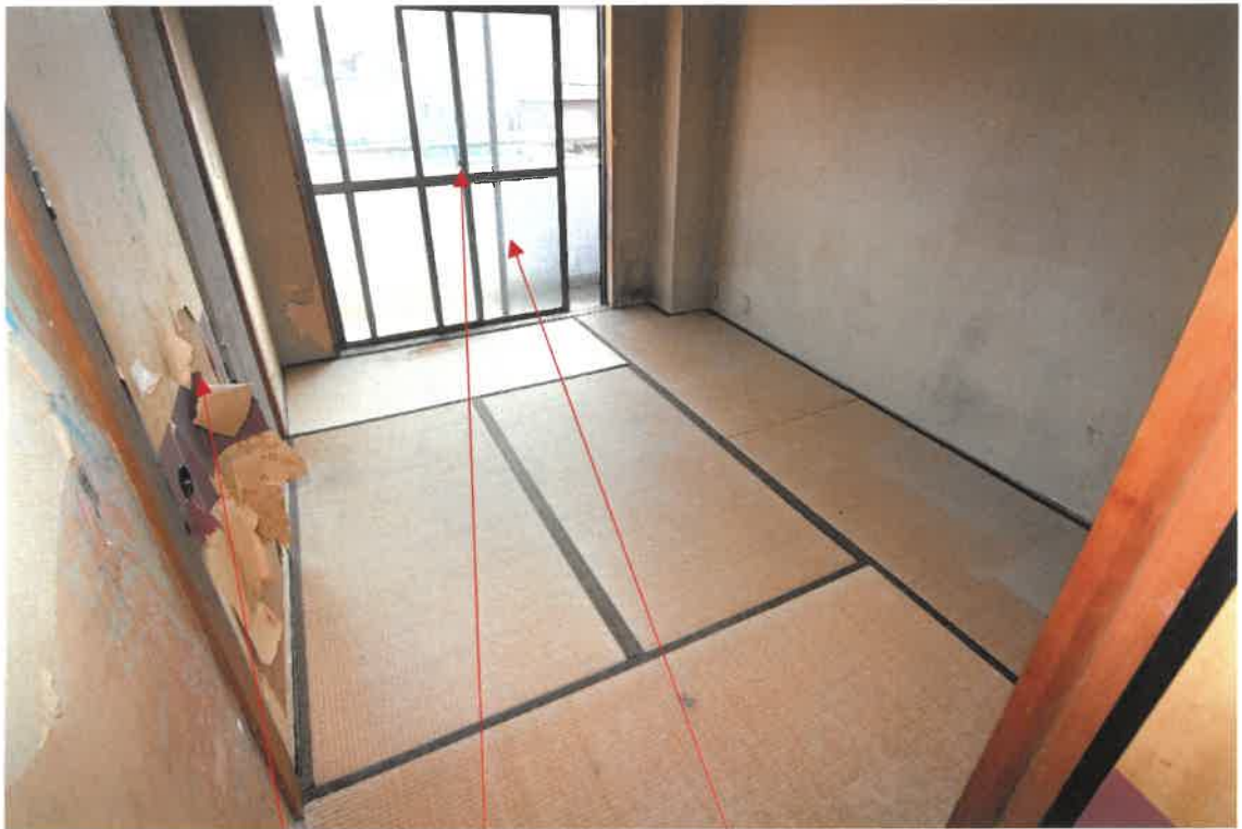
襖の破れ サッシの鍵破損 窓ガラスにひび
