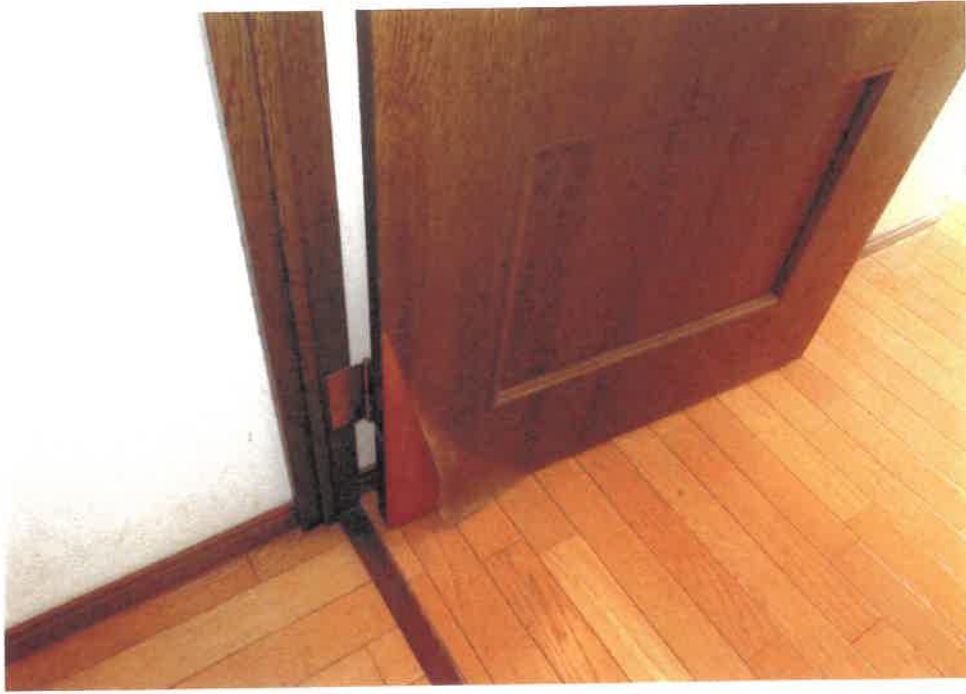
⑦ 屋内の状況（廊下とキッチンとの間の扉の装飾が剥がれている様子）
