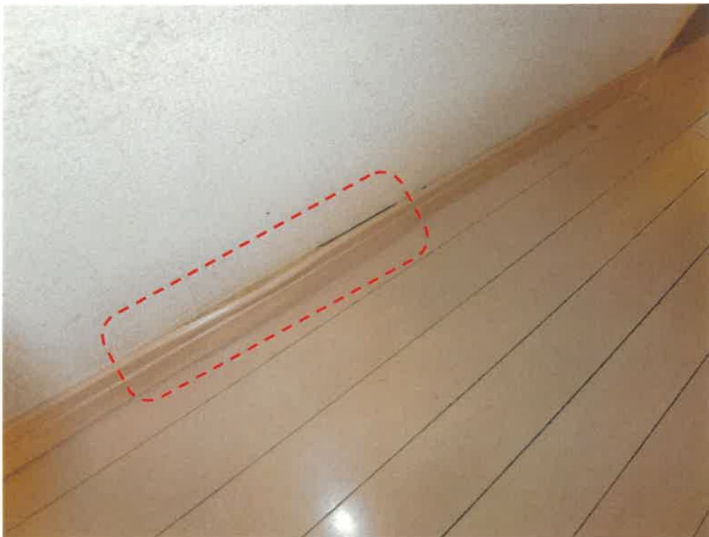
8 物件2建物内部の状況（巾木の損傷（1階廊下））
