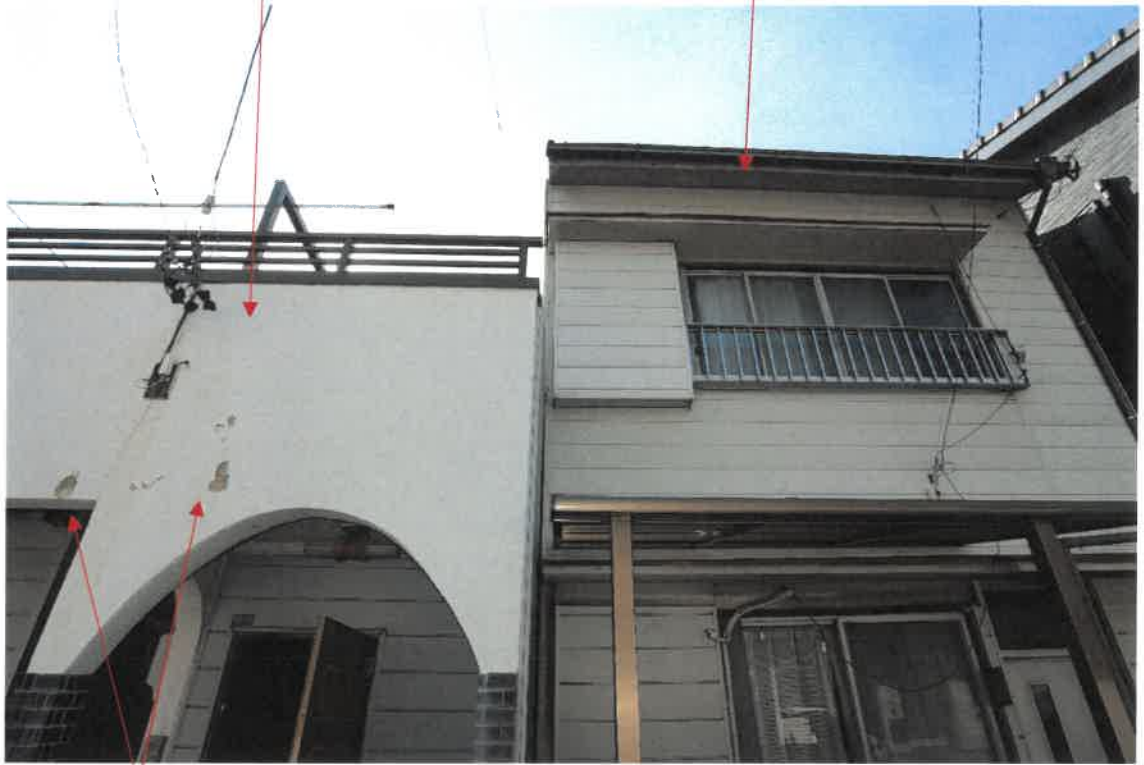
外壁塗装の剥がれ
