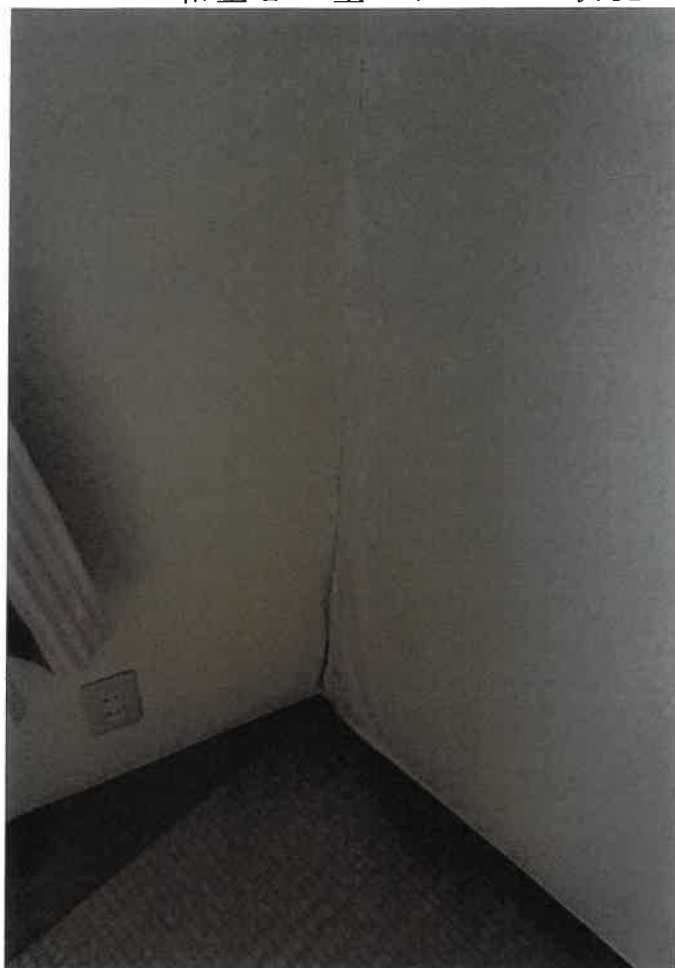
和室2の壁のクロス状況
