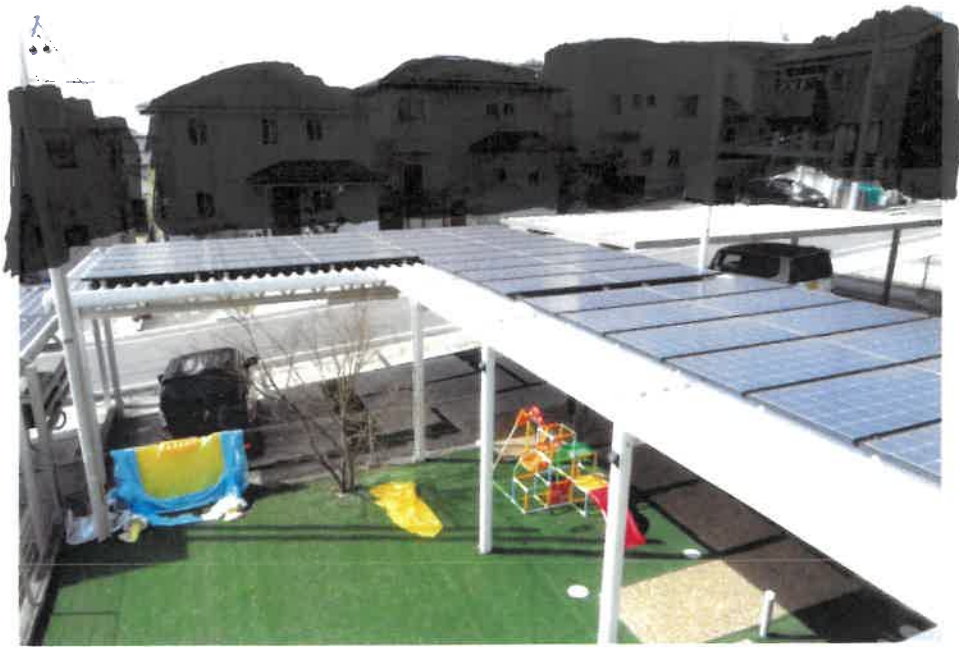
⑨ カーポート及び差掛け上の太陽光パネルの様子
