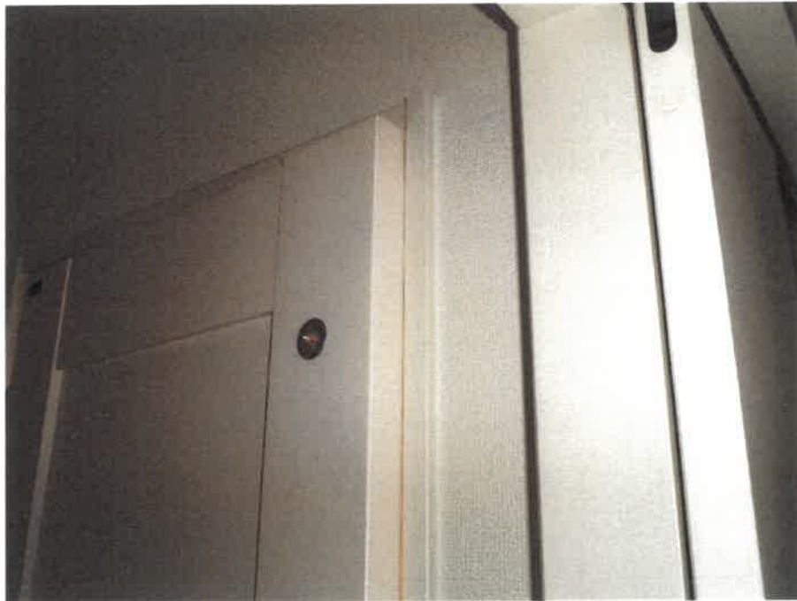
⑧ 1階トイレの扉が閉まりにくい状況
