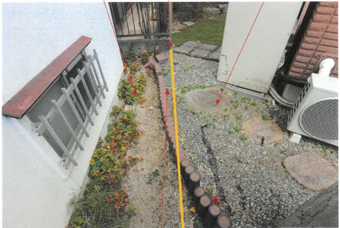
隣地(187-1)土地が越境して同土地の庭地の一部になっている部分
