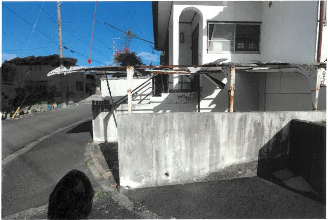
写真3 差掛けの屋根の一部が道路に越境している
